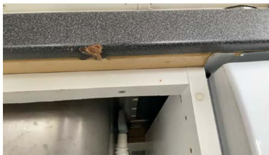
Skade på benkeplate
