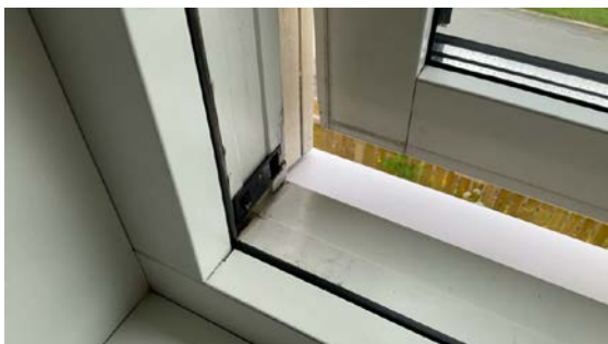
Skade på vinduskarm på soveromsvindu
