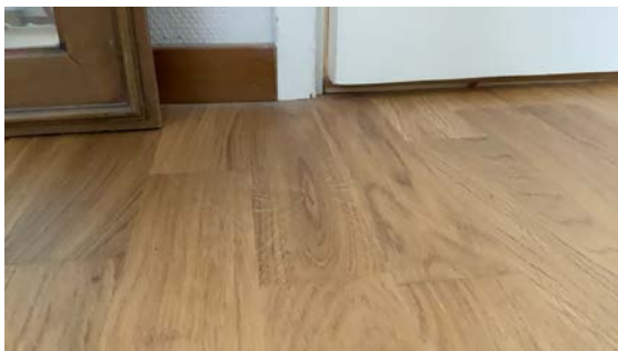
Dør til soverom tar i terskel
