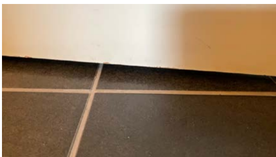
Fuktskader i nedkant av dør til bad/vaskerom
