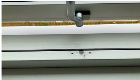
Skade på vinduskarm på soveromsvindu
