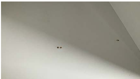
Utsvelt bunnplate, skader på overflater
