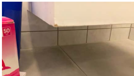
Fuktskader i nedkant av dør
