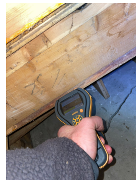
Det måles fukt i treverk over anbefalte verdier. Fuktigheten har potensiale for ytterligere skadevirkning.
