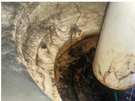
Sluk under dusj med synlig slukmansjett under klemring
