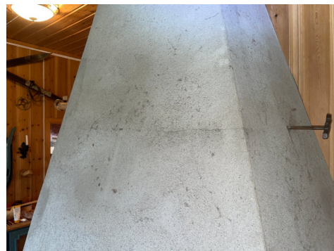
enkelte riss i overflate på peis.
