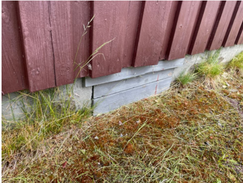
Værslitt/oppsprukket kledning i nedkant.
