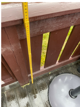
Det er målt for lav rekkverkshøyde.
