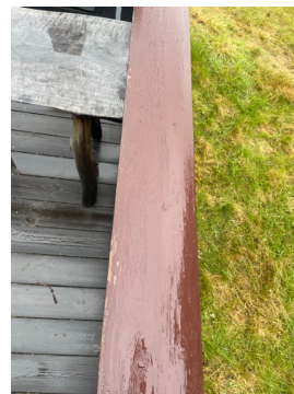
Synlig værslittasje/oppsprukket overflatebehandling.
