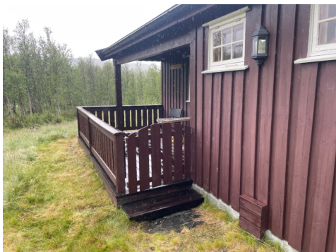
Værslitt/oppsprukket trerammer/kitt utvendig
