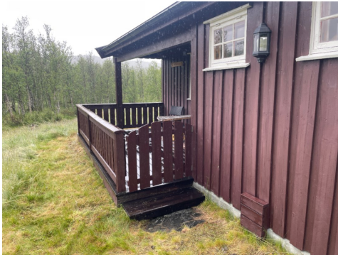
værslitt overflatebehandling på kledning
