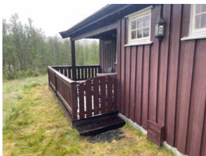
værslitt overflatebehandling på kledning
