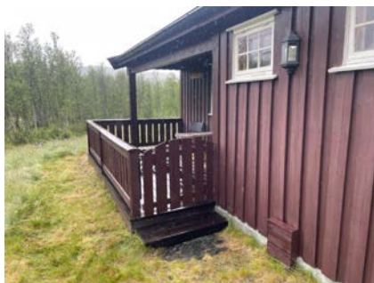
Værslitt/oppsprukket trerammer/kitt utvendig
