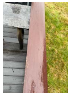
Synlig værslittasje/oppsprukket overflatebehandling.
