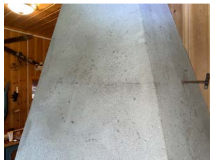
enkelte riss i overflate på peis.
