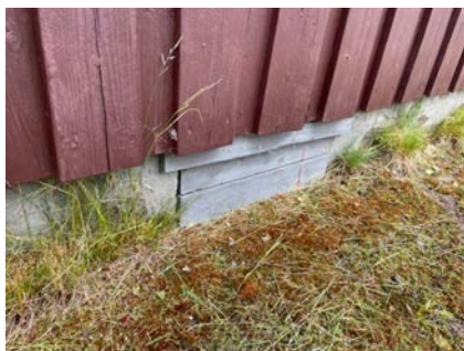
Værslitt/oppsprukket kledning i nedkant.
