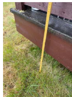
Nivåforskjell over 0,5 meter og derfor krav til rekkverk
