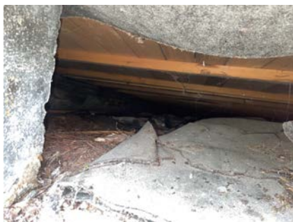
Det er ikke registrert fuktsperre mot grunn.
