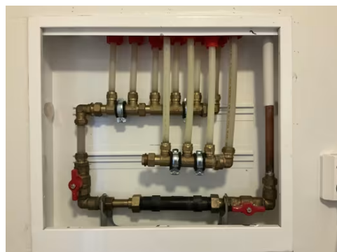
Rør-fordeling er ikke merket.
