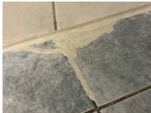
Skade på flis er dekket med silicon.
