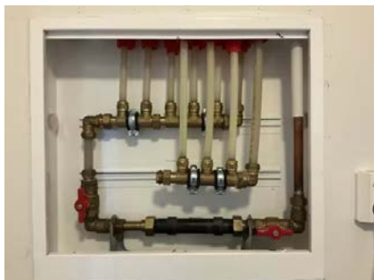
Rør-fordeling er ikke merket.
