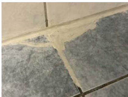
Skade på flis er dekket med silicon.
