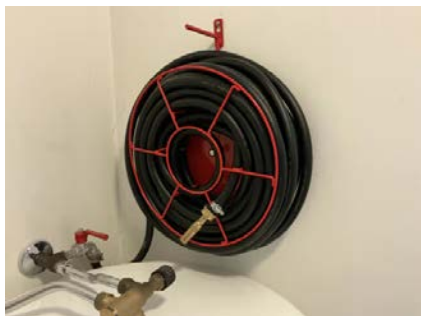
Hus-brannslange er installert i bod.
