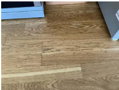
Parkett er noe slitt enkelte streder.
