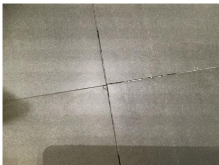
Sprukne flisfuger i entre.
