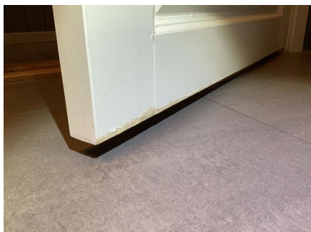
Svelleskadet dør til bad.
