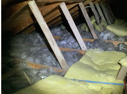
Isolasjon dekker delvis lufting mot raft.
