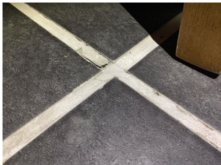
Sprukket flisfuge ved ildsted.
