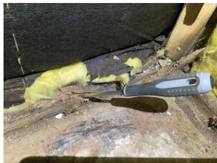
Råte observert i utforet vegg.
