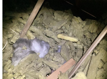
Isolering på loft er ujevn.
