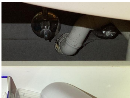
Utett rundt gjennomføring i våtsone, ufagmessig utførelse.
