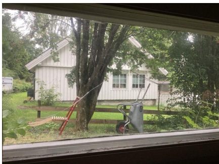
Sprukket kjellervindu. Dette forholdet utgjør tilstandsgrad 2.
