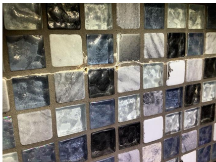
Riss i flisfuger i dusjsone.
