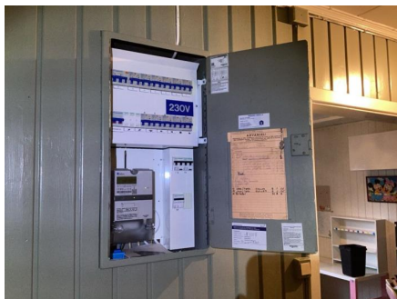
Sikringskap lokalisert i gang.
