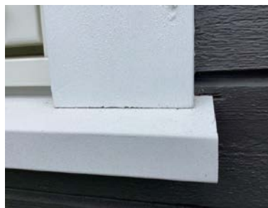
Kledning er ført ned på vannbrett, risiko for fuktopptrekk.
