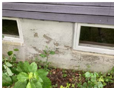
Avskalling/flassing på grunnmur.
