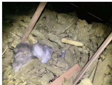
Isolering på loft er ujevn.
