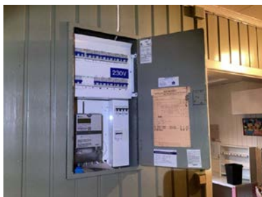
Sikringskap lokalisert i gang.
