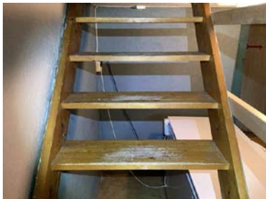
Trapp til kjeller bærer preg av slitasje.
