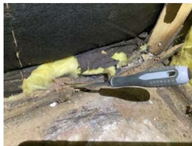
Råte observert i utforet vegg.
