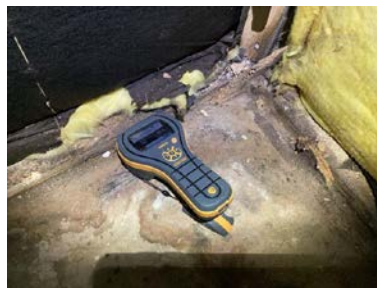
Fuktmåling ble foretatt, jeg målte skadelig fukt.
