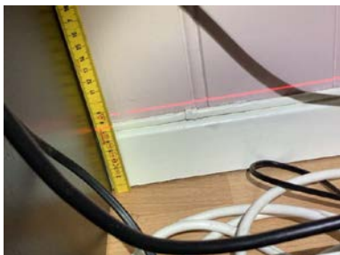
Helningsavvik på 34 mm ble målt på kontor/soverom i 1. etasje.
