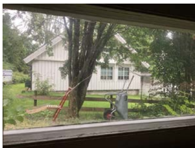
Sprukket kjellervindu. Dette forholdet utgjør tilstandsgrad 2.
