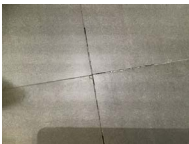
Sprukne flisfuger i entre.
