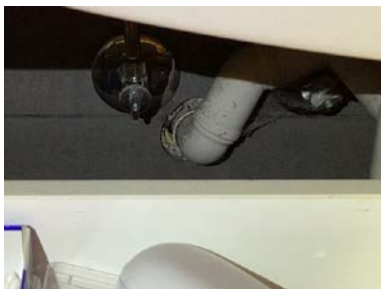
Utett rundt gjennomføring i våtsone, ufagmessig utførelse.
