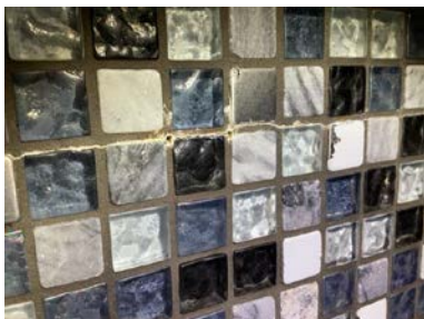
Riss i flisfuger i dusjsone.
