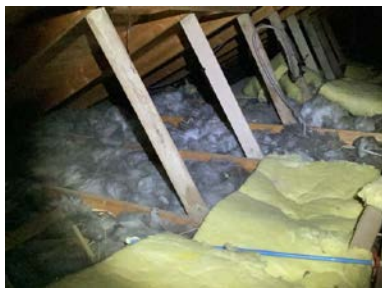
Isolasjon dekker delvis lufting mot raft.
