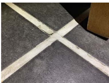
Sprukket flisfuge ved ildsted.
