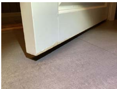
Svelleskadet dør til bad.
