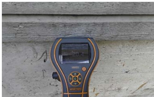
Fukt måling på utvendig kledning
