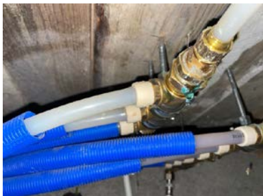
Lekkasjepunkt på fordelingsstokk.
