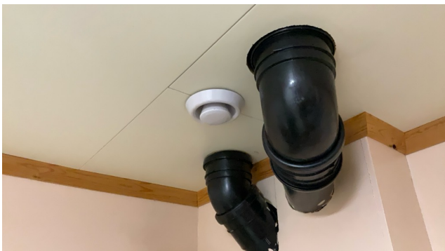
Avtrekk i himling.
