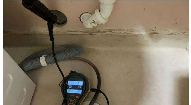
Ingen unormale forhold påvist ved hullboring i vegg på vaskerom.
