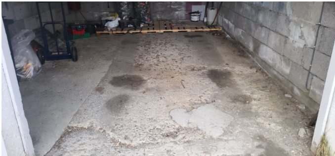
Garasjegulv har skader.
