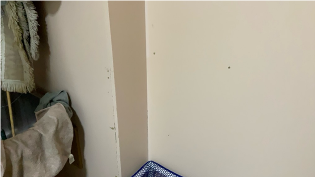
Skruehull og malingsavflassing i veggplater.
