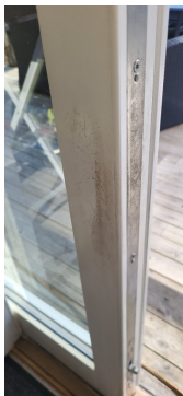
Oppskrapet karm på terrassedør.
