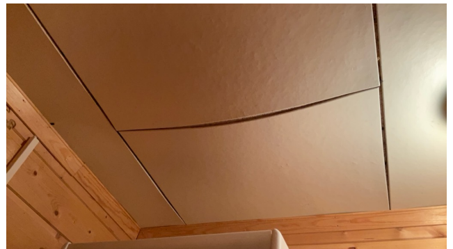
Himlingsplater er fuktskadet og utsvelt.
