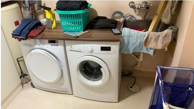
Vaskemaskin, tørketrommel og VVS-bereder.
