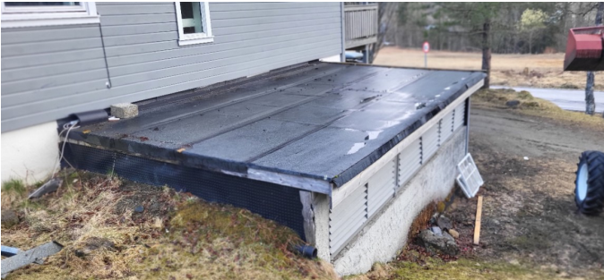
Lett tilgang til taket og fare for fallskader.
