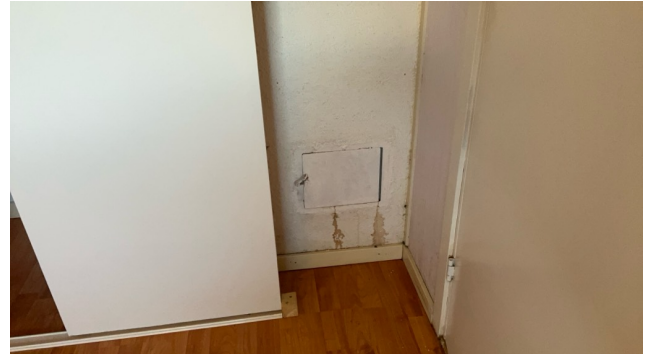
Sotluke er innenfor 30 cm. fra brennbart materiale på vegg.
