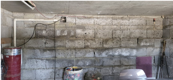
Saltutslag på bakvegg i garasje.
