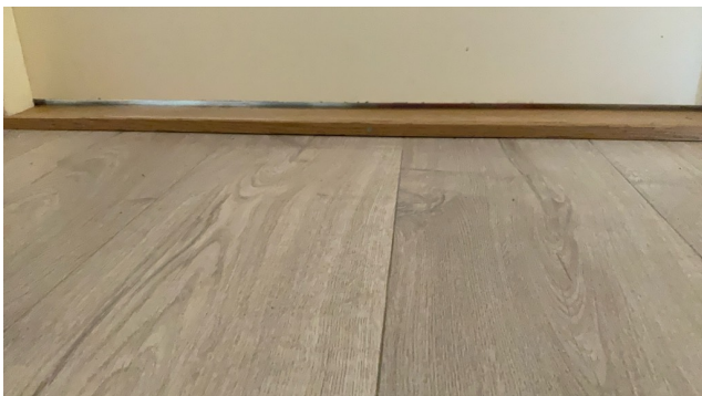
Tilluft under dørterskel
