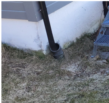
Utett overgang mellom nedløpsrør og overvannsrør under bakkenivå.
