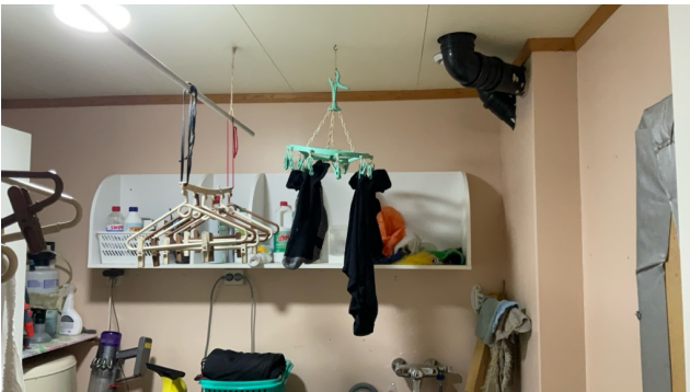
Vegger og tak på vaskerom.
