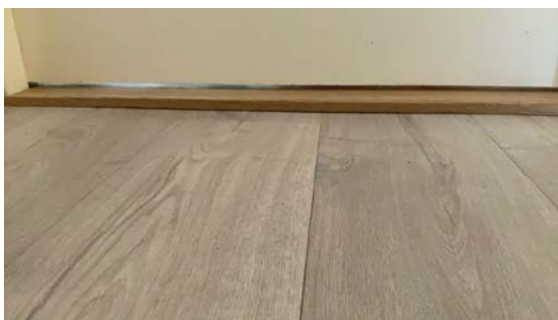
Tilluft under dørterskel
