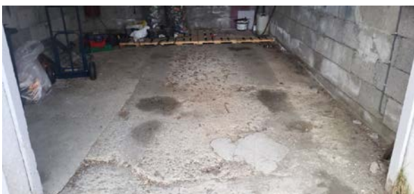
Garasjegulv har skader.
