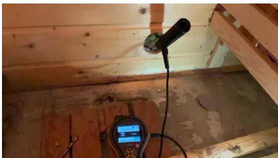
Ingen unormale forhold påvist ved hullboring i tilstøtende vegg til badet.
