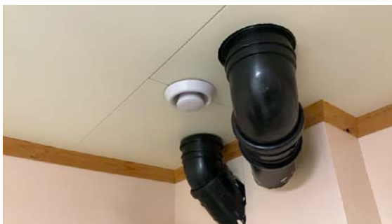
Avtrekk i himling.
