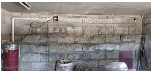
Saltutslag på bakvegg i garasje.
