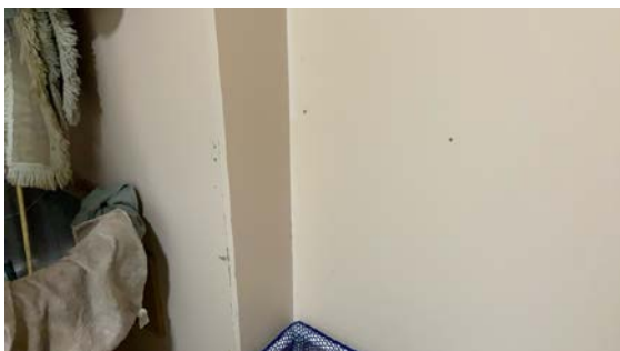
Skruehull og malingsavflassing i veggplater.
