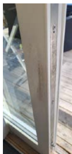
Oppskrapet karm på terrassedør.
