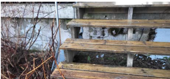
Utvendig maling og puss er løsnet på overflater på grunnmur
