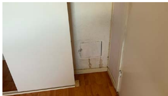
Sotluke er innenfor 30 cm. fra brennbart materiale på vegg.
