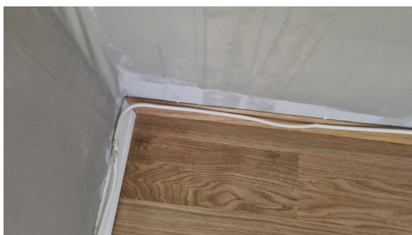
Ledning er ikke tilfredsstillende festet.
