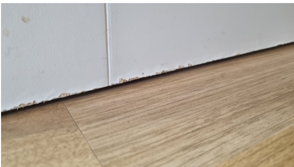
Noe fuktsvell observert i nedre del av dørbladet til baderomsdøren.
