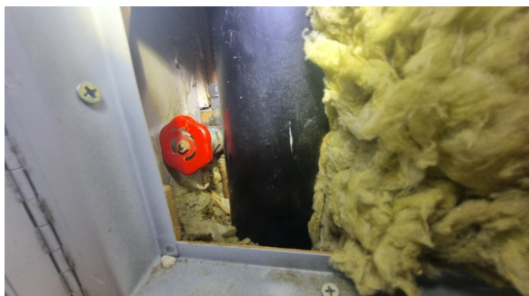
Hovedstoppekran av eldre dato uten kuleventil.
