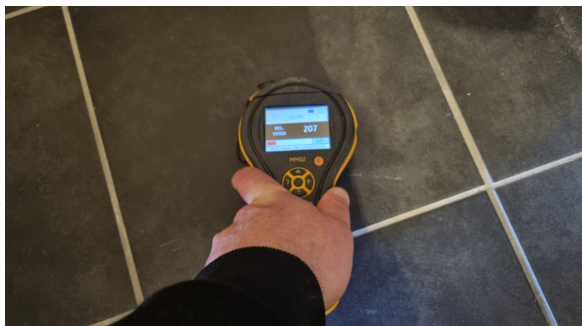
Det ble registrert forhøye fuktverdier.
