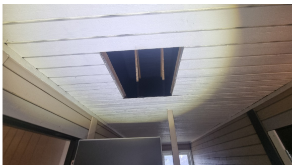
Luke i himling ved inngangsdør.
