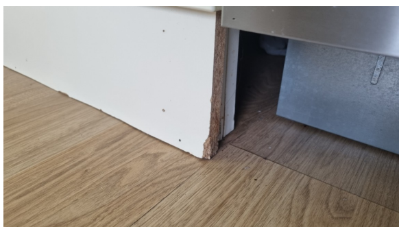
Skade/fuktsvell på sokkellist
