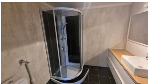
Vegger mot dusjkabinett har baderomsplater fra 2024.
