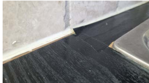
Ufagmessig utførelse av folie på benkeplate.
