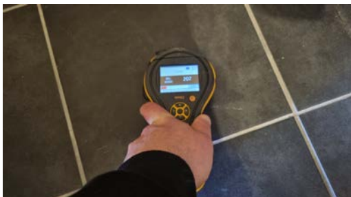
Det ble registrert forhøyde fuktverdier.
