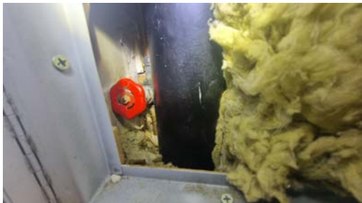
Hovedstoppekran av eldre dato uten kuleventil.
