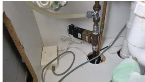
Det er montert waterguard.
