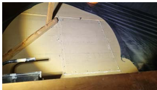
Adkomsten til kaldloftet var ved befaring igjenkledd.
