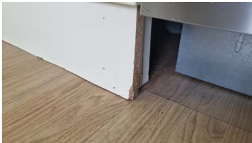
Skade/fuktsvell på sokkellist
