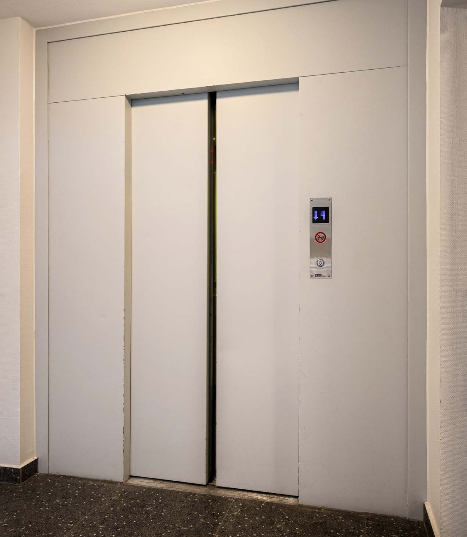
Heisen i bygget fører deg enkelt mellom etasjene.
