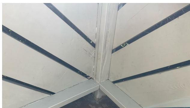
Råteskade i rekkverk.
