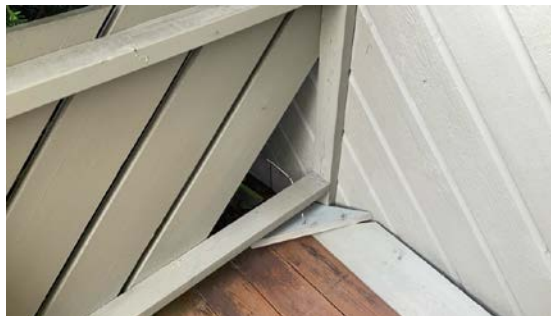
Løse bord i rekkverk.
