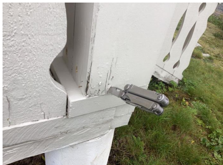
Begynnende råteskade i søyle.
