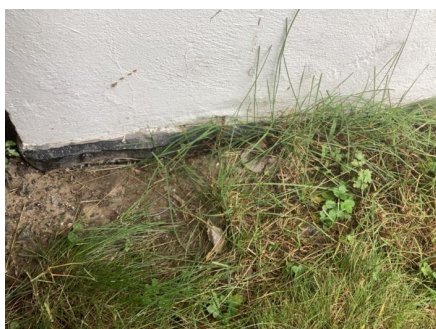
Fuktsperre er stedvis avsluttet under terreng.
