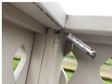
Råte i rekkverksstolpe.
