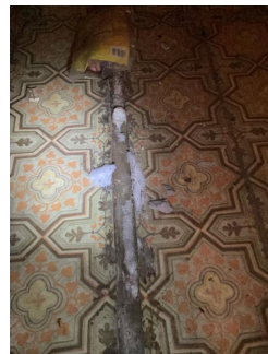
Gulvbelegg løsner fra underlag.
