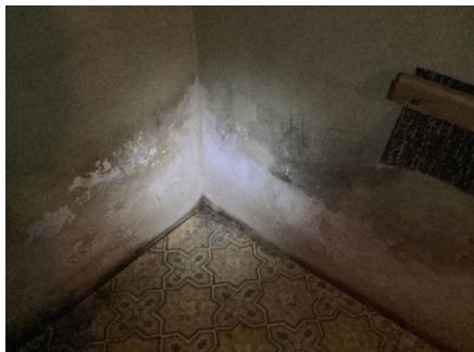
Eksempel på fuktpåkjenninger på vegg.
