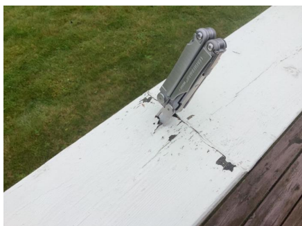
Eksempel på råte i toppbord.
