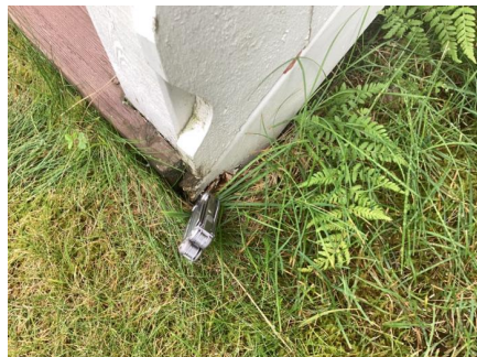
Råte i trapp som går ned i terreng.
