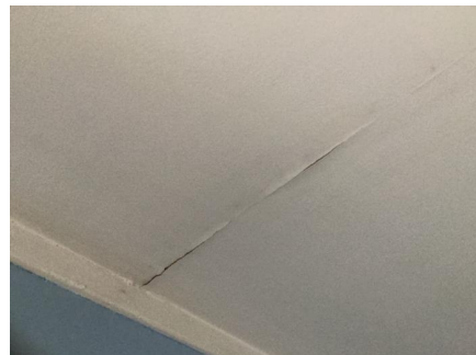
Eksempel på riss i himling.
