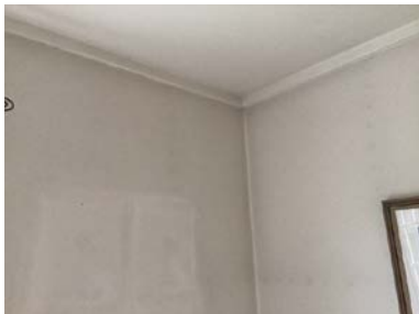
Eksempel på misfarging.
