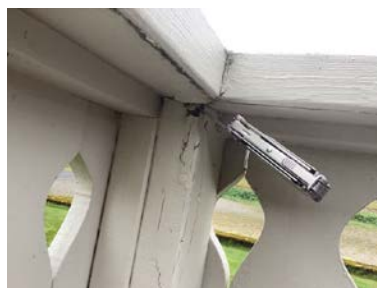
Råte i rekkverksstolpe.
