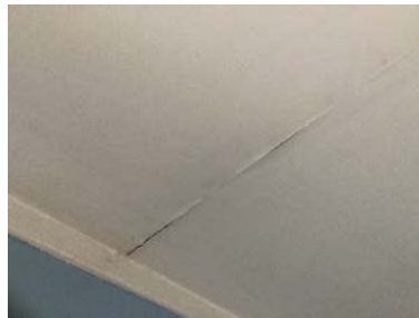
Eksempel på riss i himling.
