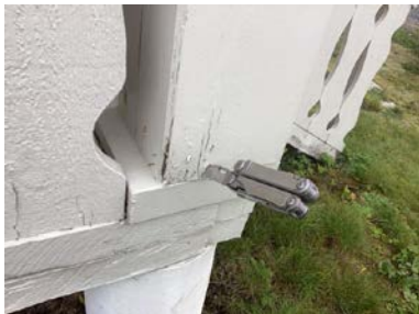
Begynnende råteskade i søyle.
