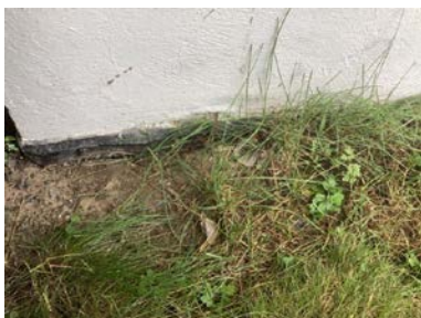
Fuktsperre er stedvis avsluttet under terreng.
