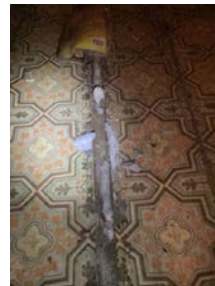
Gulvbelegg løsner fra underlag.
