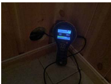
Fuktmåling i utforet vegg mot terreng.
