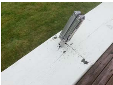
Eksempel på råte i toppbord.
