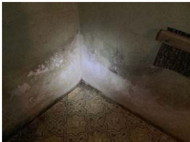
Eksempel på fuktpåkjenninger på vegg.
