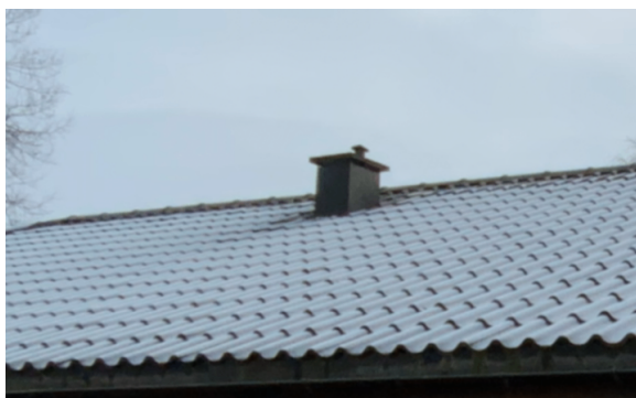
Påvist lekkasje fra luftelyre.
