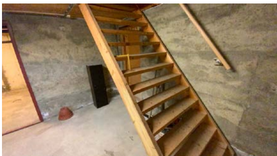
Manglende rekkverk og håndløper i trapp.
