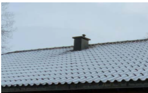
Påvist lekkasje fra luftelyre.
