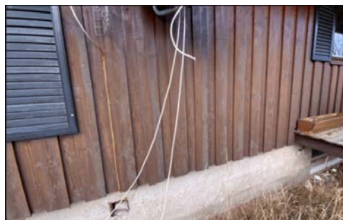
Det er oppsprukket trekledning enkelte steder mot sør.
