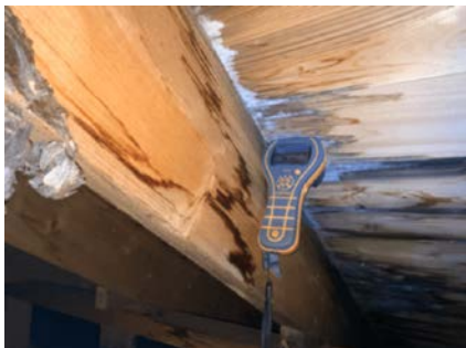
Det er påvist fukt-/råteskader i takkonstruksjonen.
