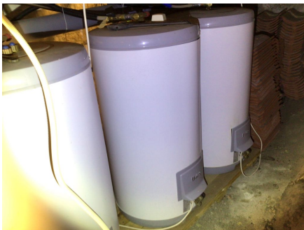
Varmtvannstank i kjeller.
