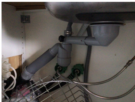
Del av rør til avløp.
