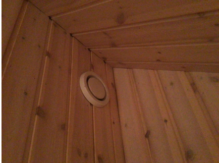
Eksempel på montert ventil i vegg.
