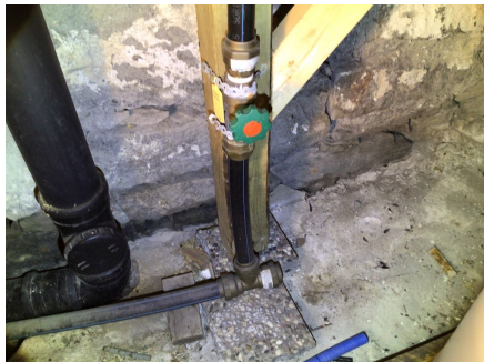
Stoppekran til vann i kjeller.
