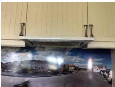
Montert avtrekk over komfyr.
