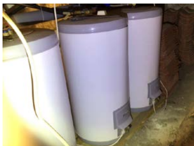
Varmtvannstank i kjeller.
