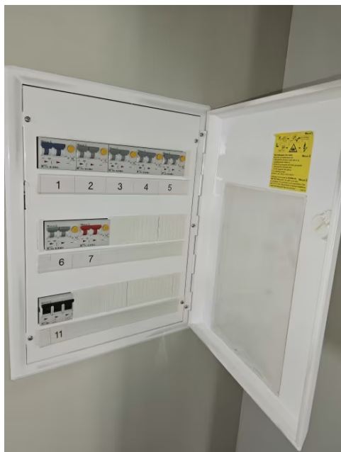
Bilde viser sikringsskap.
