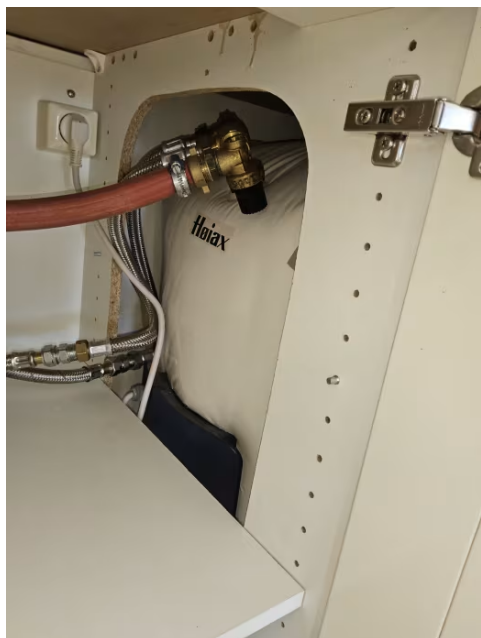
Bilde viser varmtvannsbereder.
