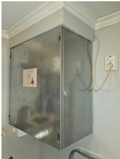
Bilde viser ventilasjonsaggregat.
