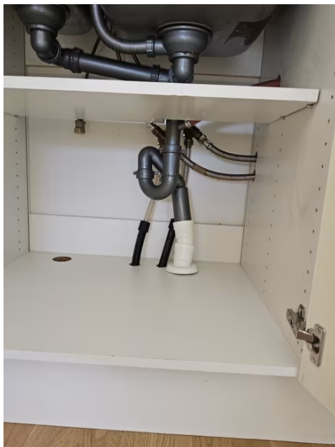
Bilde viser røropplegg under oppvaskkum på kjøkken.
