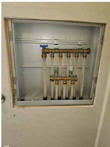
Bilde viser fordelerskap for rør i rørsystem på bad.
