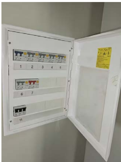
Bilde viser sikringsskap.
