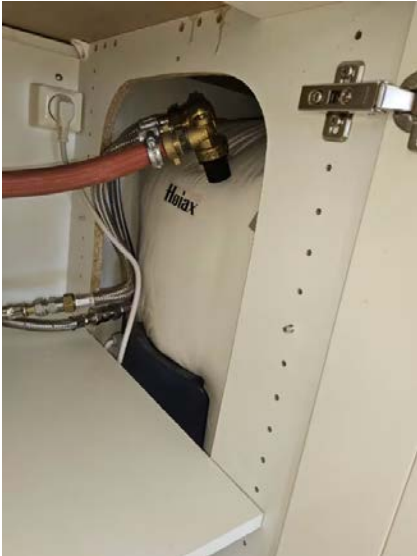
Bilde viser varmtvannsbereder.
