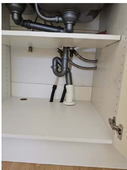
Bilde viser røropplegg under oppvaskkum på kjøkken.
