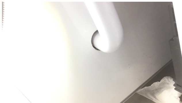
Mangelfull fuging rundt avløpsrør
