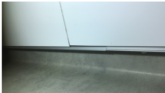
Mangler fuging i nedkant våtromsplater
