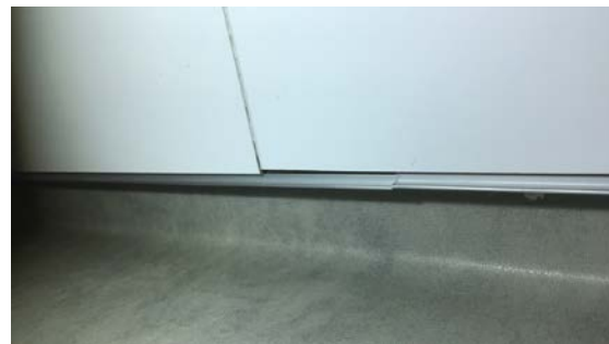
Mangler fuging i nedkant våtromsplater
