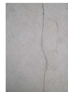
Innvendig synlig sprekk i grunnmur.
