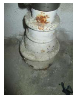
Gamle avløpsrør i kjellergulvet.
