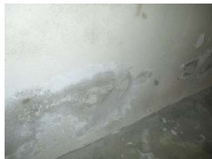
Noe fuktvandring og salutslag.
