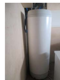
Stor bereder er plassert i grovkjeller.
