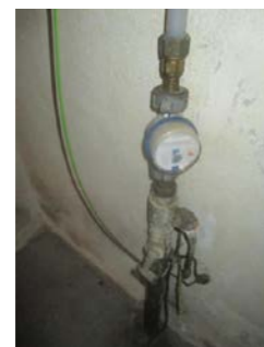
Innvendig stoppekran med vannmåler i grovkjeller.
