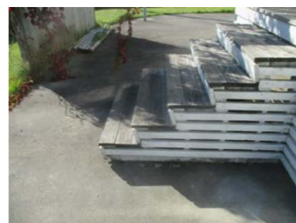
Skulle vært rekkverk på trappen.
