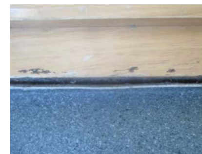
Løsnet ved oppkant til dør.
