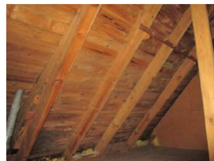
Noe misfarging av undertaket enkelte steder.
