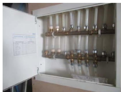
Fordelerskapet er plassert i grovkjeller.
