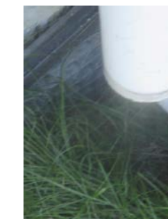
Taknedløp må ledes bort i fra grunnmur.
