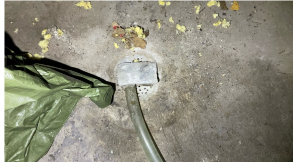
Sluk i støpejern i gulv.
