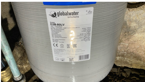
Trykktank i kjelleren.
