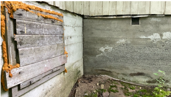
Sprekk i grunnmur.
