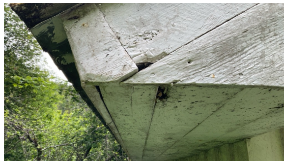
Noe begynnende råte i vindskier.
