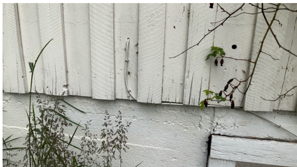
Sprekker og svartsopp på kledning.
