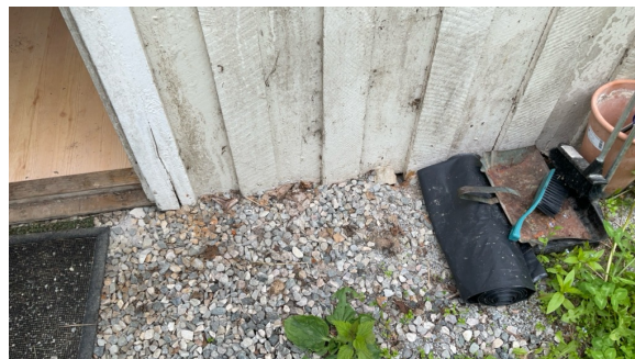
Det mangler avstand mellom kledning og terreng.
