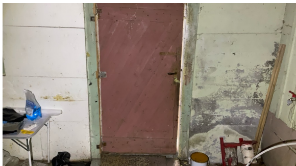
Råte i kjellerdør.
