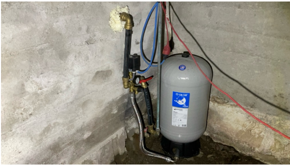
Trykktank i kjelleren.
