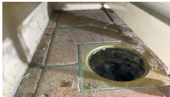
Sluk under dusjkabinett.
