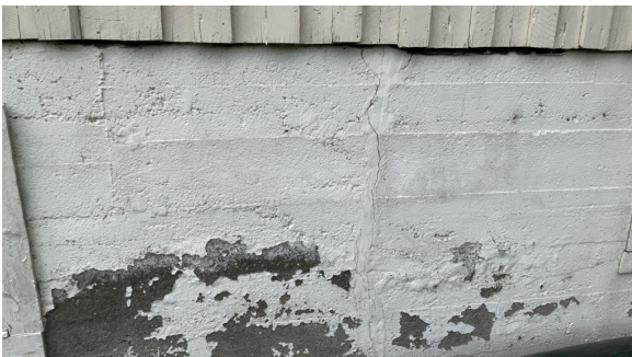
Sprekk i grunnmur og løs/manglende maling.
