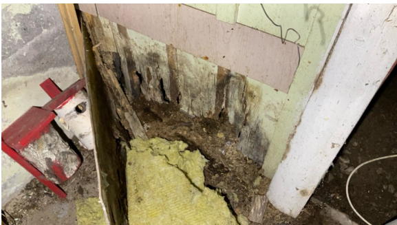
Råte i vegg bak vaskemaskin
