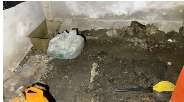
Fukt i kjelleren
