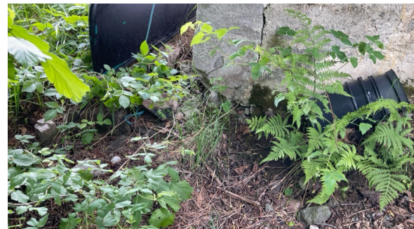
Utglijning av masser under fundamenter.
