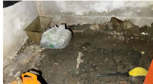
Fukt i kjelleren
