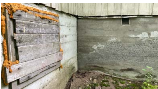
Sprekk i grunnmur.
