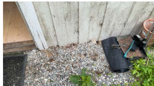
Det mangler avstand mellom kledning og terreng.
