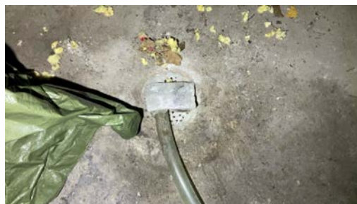
Sluk i støpejern i gulv.
