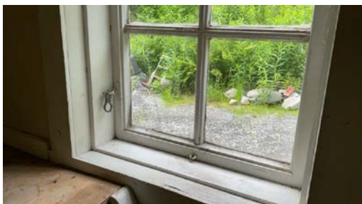
Enkelt glass i vindu i gang. Det er en rute med sprekt/knust glass.
