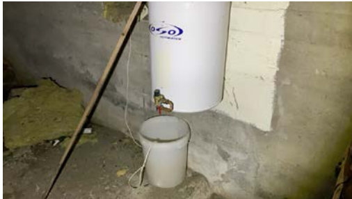
Varmtvannstank i kjellern.
