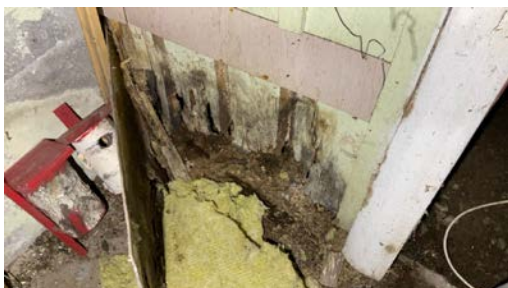
Råte i vegg bak vaskemaskin
