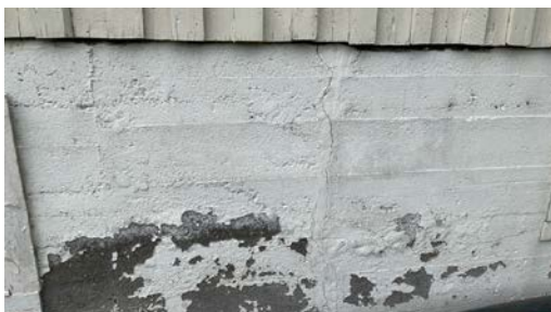
Sprekk i grunnmur og løs/manglende maling.
