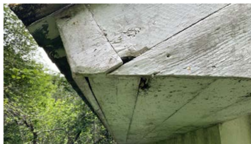
Noe begynnende råte i vindskier.
