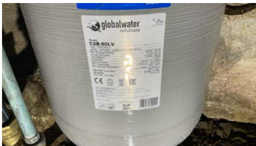
Trykktank i kjelleren.
