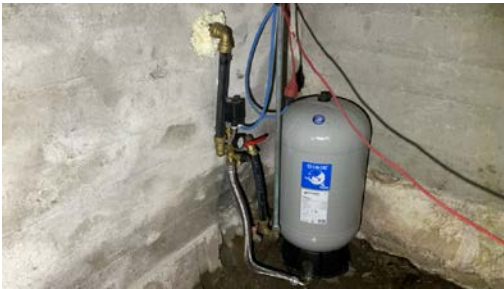
Trykktank i kjelleren.
