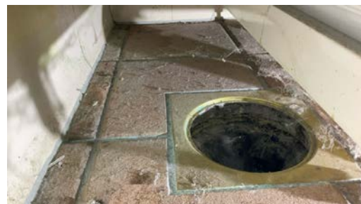
Sluk under dusjkabinett.
