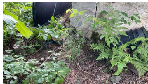
Utglijning av masser under fundamenter.
