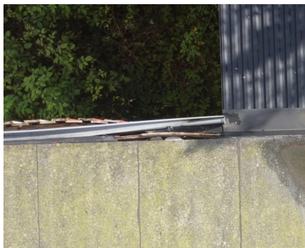
Bak vegg synlig skjevheter
