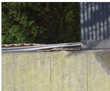
Bak vegg synlig skjevheter
