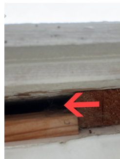
Eksempel på manglende musesperre.
