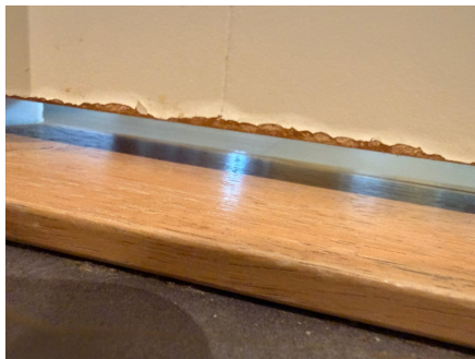
Fuktskader i nedkant av døren tilbadet.
