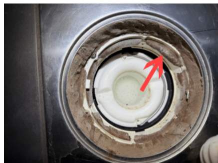
Smøremembran mangler på slukmansjetten.
