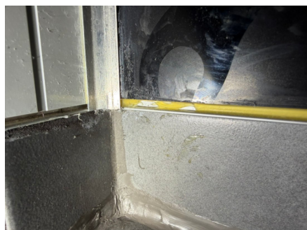
Utette overganger mellom lister og baderomsplater.
