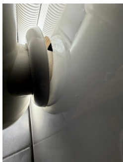
Eksempel på utett rørgjennomføring.
