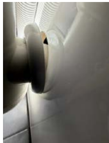
Eksempel på utett rørgjennomføring.
