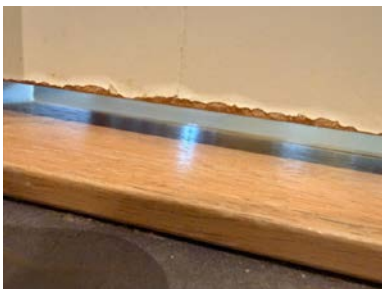
Fuktskader i nedkant av døren tilbadet.
