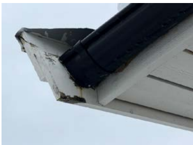
Værslitt overflatebehandling på vindslibord.
