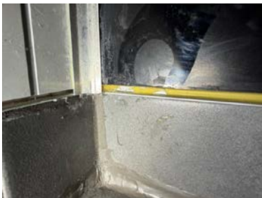
Utette overganger mellom lister og baderomsplater.
