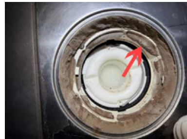
Smøremembran mangler på slukmansjetten.
