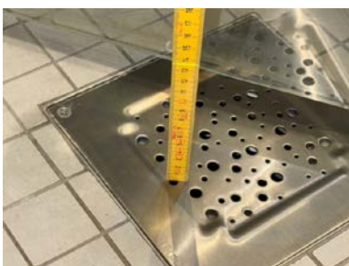
Fallforhold ca. 135 mm topp slukrist i dusjsone
