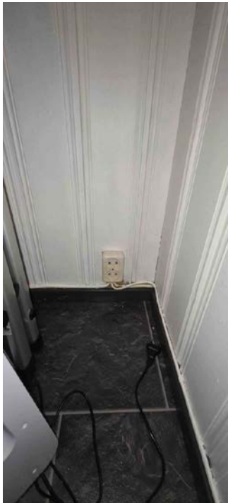
Skjema: "Brannforebyggende Elkontroll Bolig: Elkontroll bolig NEK 405-2-2" Spørsmål: Merknad Beskrivelse: Kabel gang må legges fagmessig, Filnavn: IMG_20241002_100055.jpg
