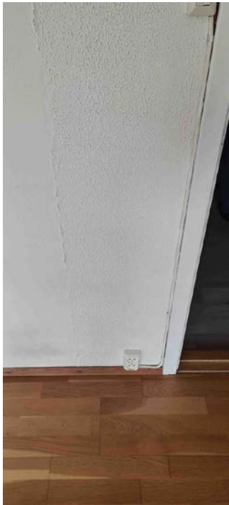
Skjema: "Brannforebyggende Elkontroll Bolig: Elkontroll bolig NEK 405-2-2" Spørsmål: Kabler, ledninger, fastmontert utstyr og forbrukerutstyr Beskrivelse: Stikk kjellerstove er løs og må festes, Filnavn: IMG_20241002_104704.jpg
