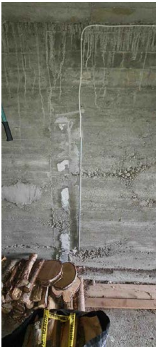
Skjema: "Brannforebyggende Elkontroll Bolig: Elkontroll bolig NEK 405-2-2" Spørsmål: Kabler, ledninger, fastmontert utstyr og forbrukerutstyr Beskrivelse: Kabel utvendig bod mangler fester på rør, Filnavn: IMG_20241002_104048.jpg
