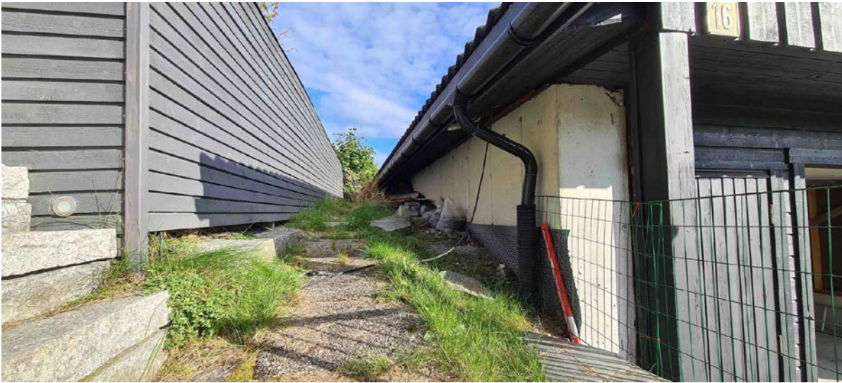
Skjema: "Brannforebyggende Elkontroll Bolig: Elkontroll bolig NEK 405-2-2" Spørsmål: Merknad (Målt verdi) Beskrivelse: Lys utvendig trapp forsynt med skjøteledning fra innvendig garasje. Installasjonskabel må benyttes, Filnavn: IMG_20241002_114317.jpg
