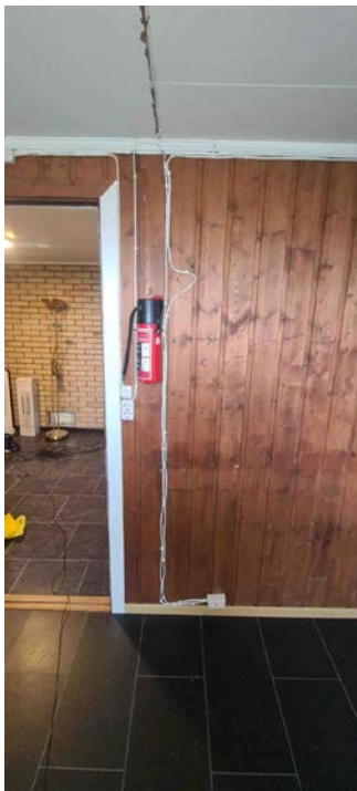
Skjema: "Brannforebyggende Elkontroll Bolig: Elkontroll bolig NEK 405-2-2" Spørsmål: Merknad Beskrivelse: Bod kjeller, ufagmessig installasjon. må legges om av autorisert installatør., Filnavn: IMG_20241002_100336.jpg
