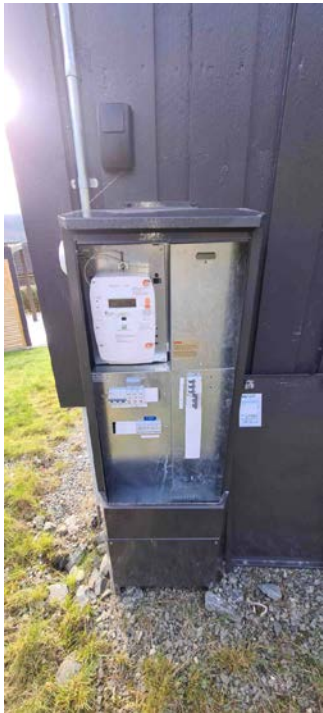
Skjema: "Brannforebyggende Elkontroll Bolig: Elkontroll bolig NEK 405-2-2" Spørsmål: Kabler, ledninger, fastmontert utstyr og forbrukerutstyr Beskrivelse: Tilknytningsskap, manglende kursfortegnelse. Kursfortegnelse må ajourføres og monteres i TKS, Filnavn: IMG_20241002_103711.jpg
