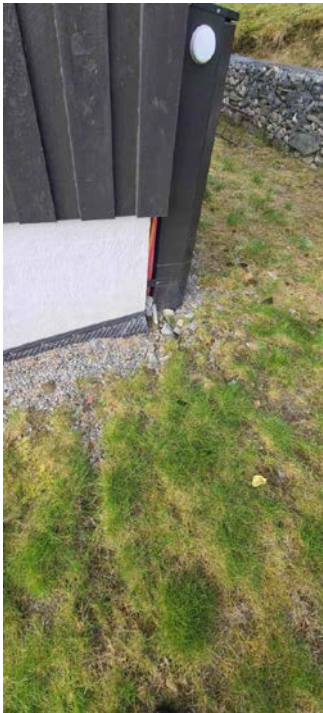
Skjema: "Brannforebyggende Elkontroll Bolig: Elkontroll bolig NEK 405-2-2" Spørsmål: Kabler, ledninger, fastmontert utstyr og forbrukerutstyr Beskrivelse: Tilførsel garasje, rør mangler mekanisk beskyttelse og er ikke gravd ned dypt nok, Filnavn: IMG_20241002_103932.jpg
