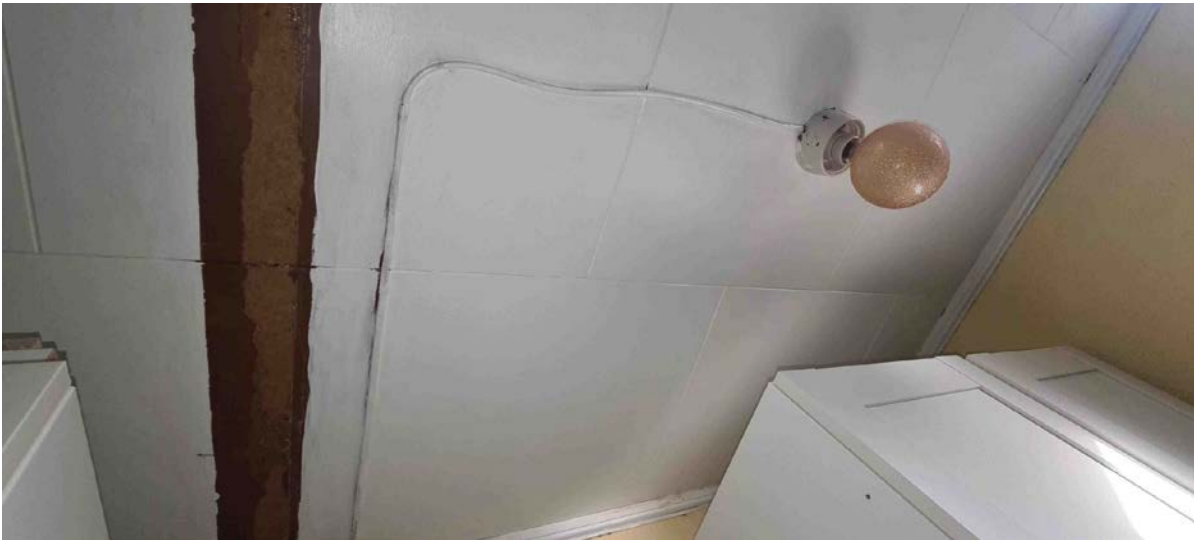
Skjema: "Brannforebyggende Elkontroll Bolig: Elkontroll bolig NEK 405-2-2" Spørsmål: Merknad Beskrivelse: Bod kjeller, kabel til lampe må festes, Filnavn: IMG_20241002_100414.jpg
