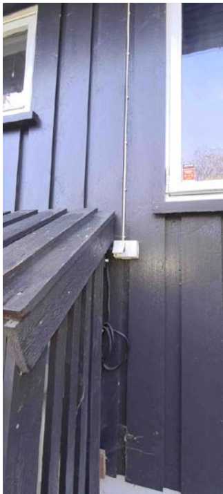
Skjema: "Brannforebyggende Elkontroll Bolig: Elkontroll bolig NEK 405-2-2" Spørsmål: Kabler, ledninger, fastmontert utstyr og forbrukerutstyr Beskrivelse: Stikk for varmepumpe, kabel ført inni bakkant uten nippel, Filnavn: IMG_20241002_103750.jpg
