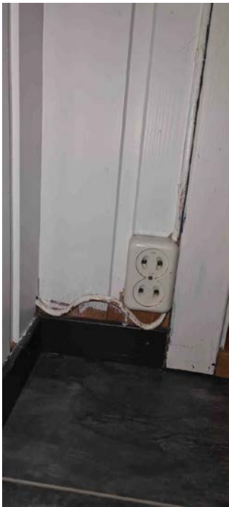
Skjema: "Brannforebyggende Elkontroll Bolig: Elkontroll bolig NEK 405-2-2" Spørsmål: Merknad
