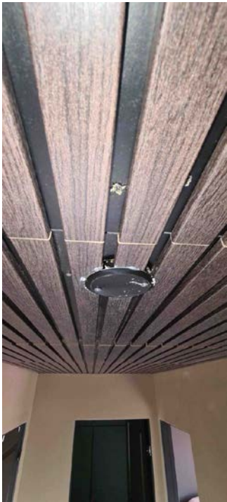
Skjema: "Brannforebyggende Elkontroll Bolig: Elkontroll bolig NEK 405-2-2" Spørsmål: Kabler, ledninger, fastmontert utstyr og forbrukerutstyr Beskrivelse: Manglende utforingsring tak gang hovedetg, Filnavn: IMG_20241002_110205.jpg
