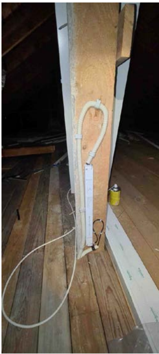
Skjema: "Brannforebyggende Elkontroll Bolig: Elkontroll bolig NEK 405-2-2" Spørsmål: Kabler, ledninger, fastmontert utstyr og forbrukerutstyr Beskrivelse: Drriver loft, rør må tettes, Filnavn: IMG_20241002_110601.jpg
