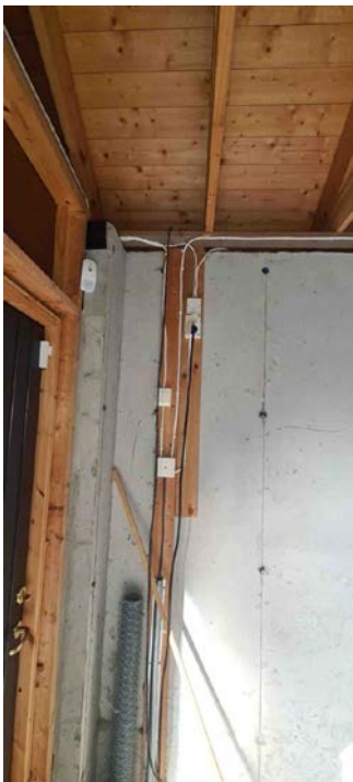
Skjema: "Brannforebyggende Elkontroll Bolig: Elkontroll bolig NEK 405-2-2" Spørsmål: Merknad Beskrivelse: Garasje, ufagmessig utført og må reinstallerer av autorisert installatør, Filnavn: IMG_20241002_102829.jpg
