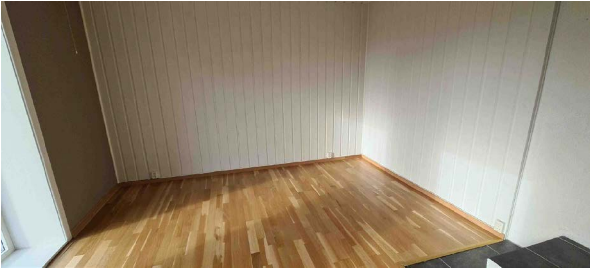
Skjema: "Brannforebyggende Elkontroll Bolig: Elkontroll bolig NEK 405-2-2" Spørsmål: Kabler, ledninger, fastmontert utstyr og forbrukerutstyr Beskrivelse: Stikkontakter mangler tilføse il kjellerstove.Stikkontakt til venstre mangler tilkoblingsskrue og m, Filnavn: IMG_20241002_104728.jpg
