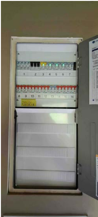
Skjema: "Brannforebyggende Elkontroll Bolig: Elkontroll bolig NEK 405-2-2" Spørsmål: Merknad Beskrivelse: Bilde sikringsskap, mangler avdekning, Filnavn: IMG_20241002_112523.jpg
