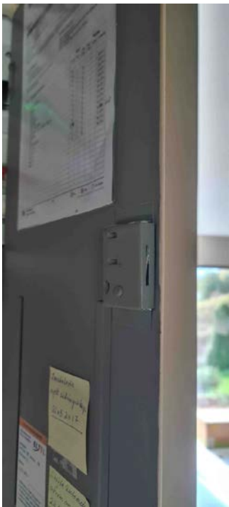
Skjema: "Brannforebyggende Elkontroll Bolig: Elkontroll bolig NEK 405-2-2" Spørsmål: Merknad Beskrivelse: Defekt lås i sikringsskap, Filnavn: IMG_20241002_112621.jpg
