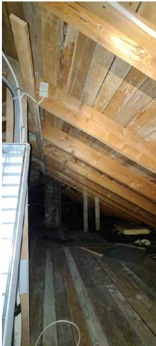
Skjema: "Brannforebyggende Elkontroll Bolig: Elkontroll bolig NEK 405-2-2" Spørsmål: Kabler, ledninger, fastmontert utstyr og forbrukerutstyr Beskrivelse: Stikkontakter loft er både av jordet og ujordet utførelse. Jordet stikkontakt mangler jord., Filnavn: IMG_20241002_110641.jpg
