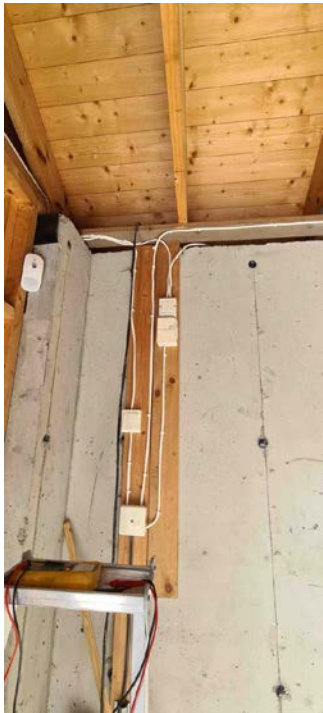
Skjema: "Brannforebyggende Elkontroll Bolig: Elkontroll bolig NEK 405-2-2" Spørsmål: Merknad (Målt verdi) Beskrivelse: Stikk v/dør i garasje mangler jord, tydelig ufagmessig utført, Filnavn: IMG_20241002_114254.jpg
