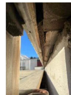
Bilde av underkant kledning uten lufting.
