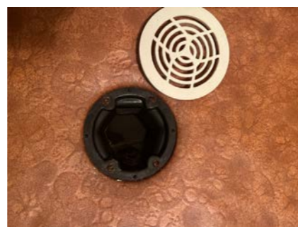
Gulvbelegg har revnet.
