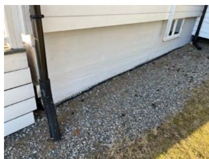
Grunnmursplast mangler topplist.
