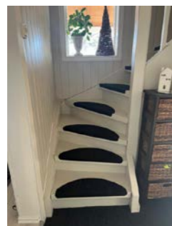
Trapp til loftetasje bør utbedres.
