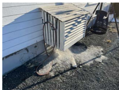
Vann fra utedel varmepumpe bør ledes vekk.
