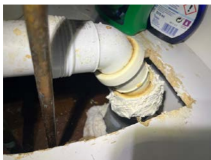
Avløpsrør i kjøkkenbenk er tettet med fugemasse.
