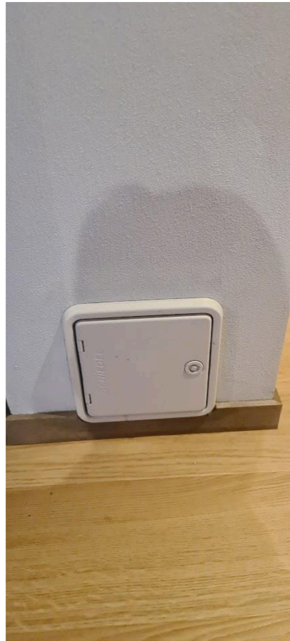
Sotluke med gulvlist og sotluke ca 60mm over eikegulv.
