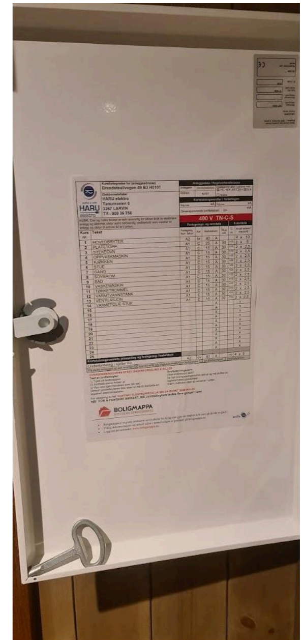
Kursfortegnelse i sikringskap.
