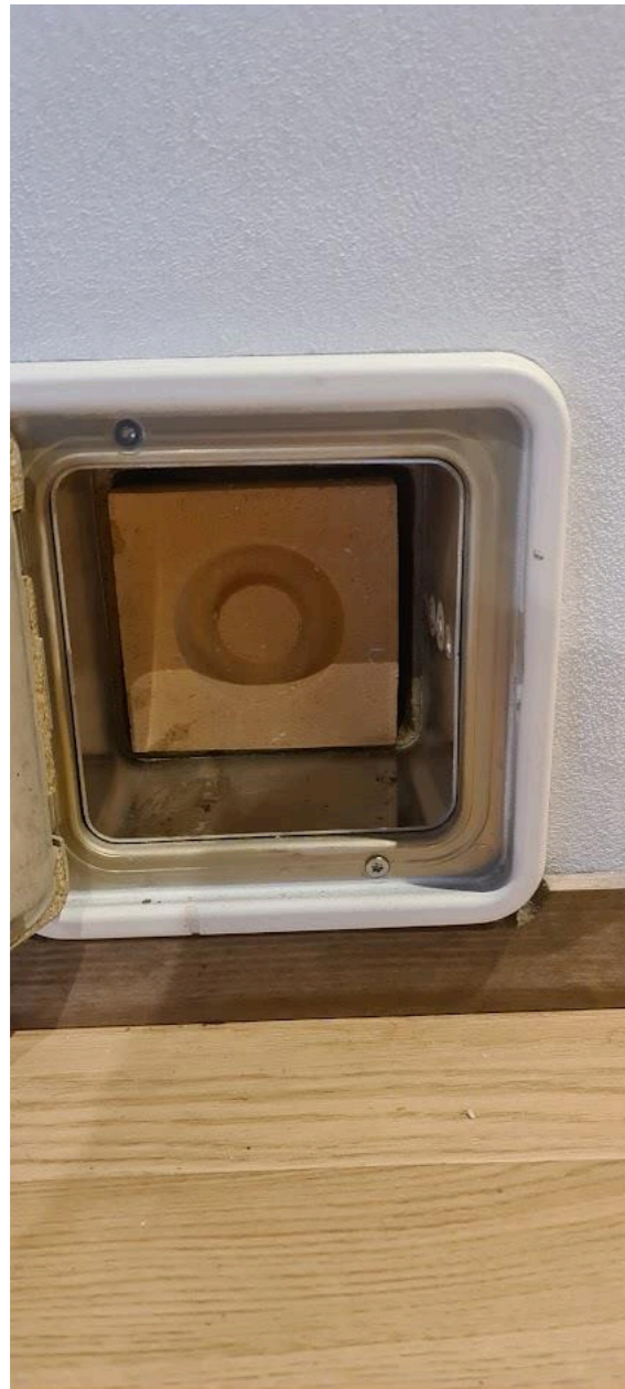
Sotluke åpnet med synlig stein inn mot røykrør/pipe.
