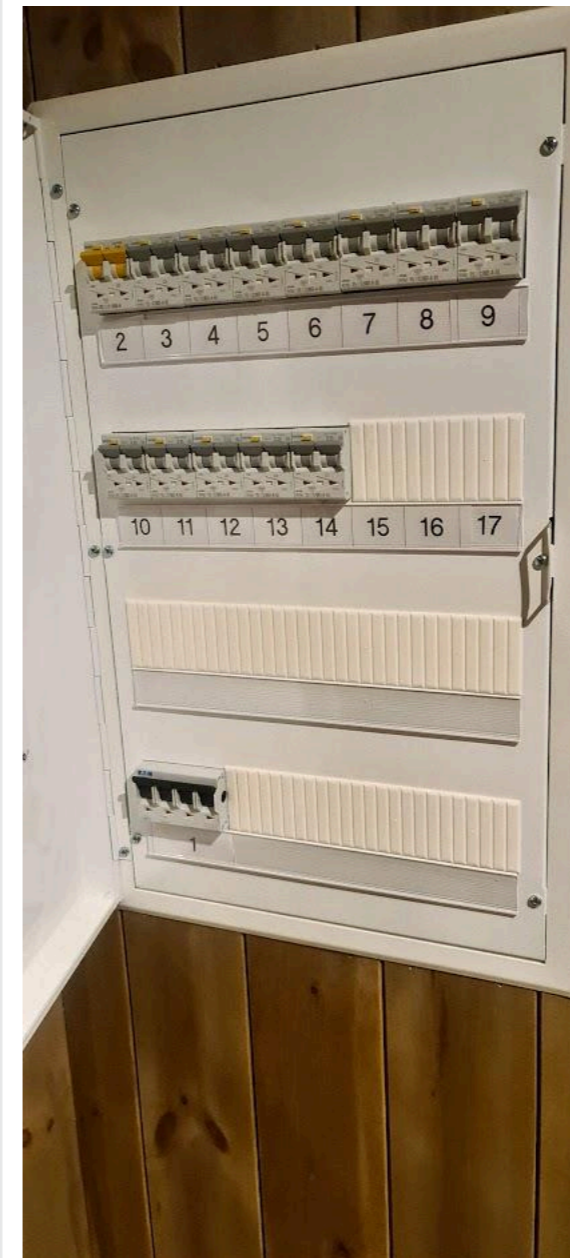
Sikringskap med jordfeilatomaticringer
