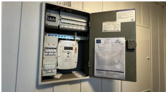
Kontroll av el-skap og kursfortegnelse.
