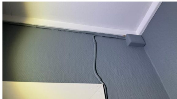
Kabler er ikke tilfredsstillende festet.
