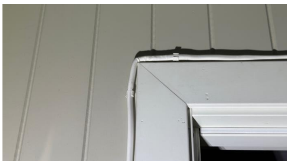
Ufagmessig utførelse av el-kabler.
