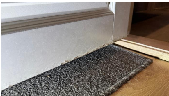
Skade/fuktsvell på badedøren.
