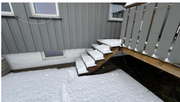
Trappen mangler rekkverk.
