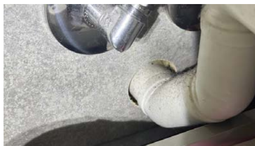
Det er påvist utette rørgjennomføringer i våtsone.
