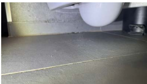
Drensåpning for synliggjøring av eventuelt lekkasjevann fra sistene.
