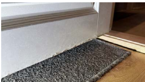
Skade/fuktsvell på badedøren.
