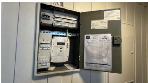
Kontroll av el-skap og kursfortegnelse.
