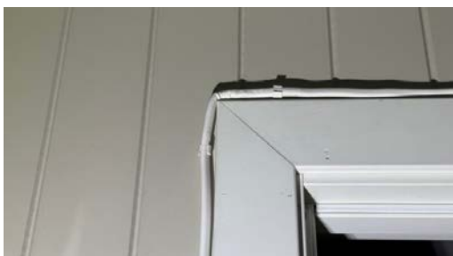
Ufagmessig utførelse av el-kabler.
