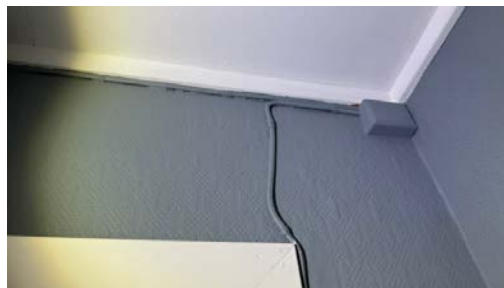
Kabler er ikke tilfredsstillende festet.
