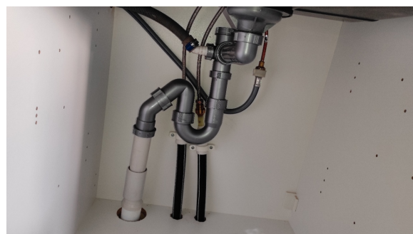
Kontroll etter lekkasjer.
