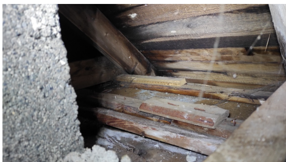
Fukt på kladloftet.
