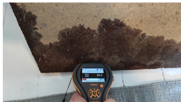
Fuktmåling i loftsluken.
