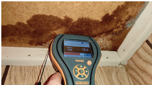
Fuktmåling i himlingen i gangen.
