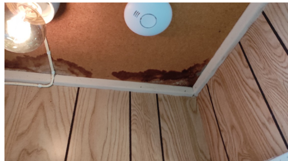
Fuktmerker i himlingen i gangen.
