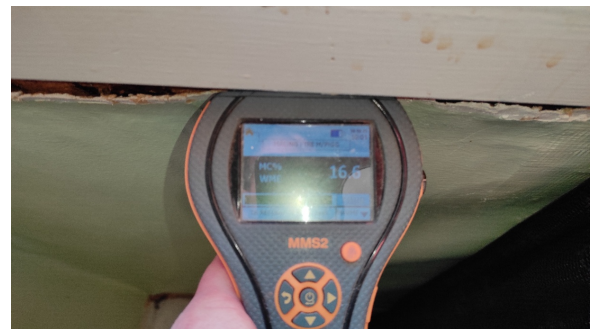
Fuktmåling under vinduet i loftetasjen.
