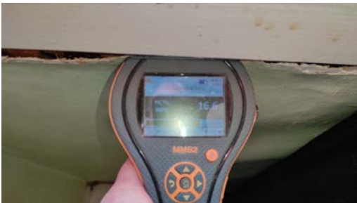
Fuktmåling under vinduet i loftetasjen.
