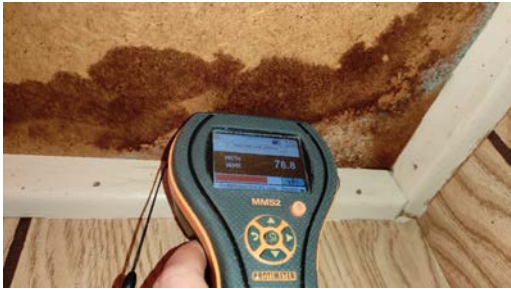
Fuktmåling i himlingen i gangen.
