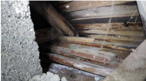
Fukt på kladloftet.
