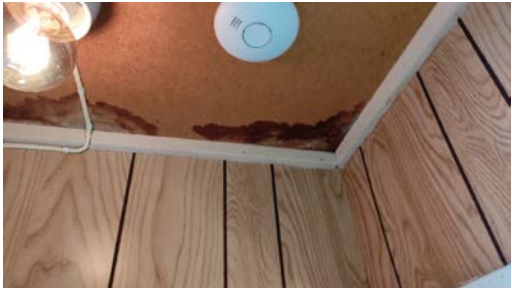
Fuktmærker i himlingen i gangen.
