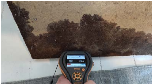
Fuktmåling i loftsluken.
