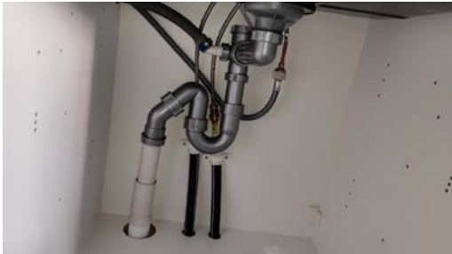
Kontroll etter lekkasjer.
