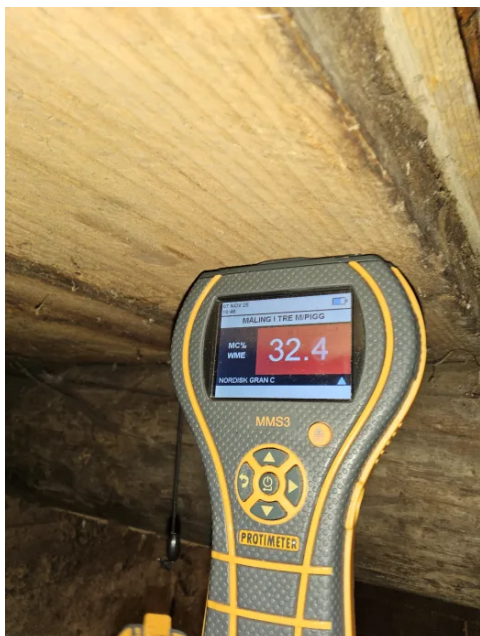
Bilde viser fuktmåling i kjeller.
