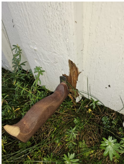
Bilde viser råteskade på yttervegg.
