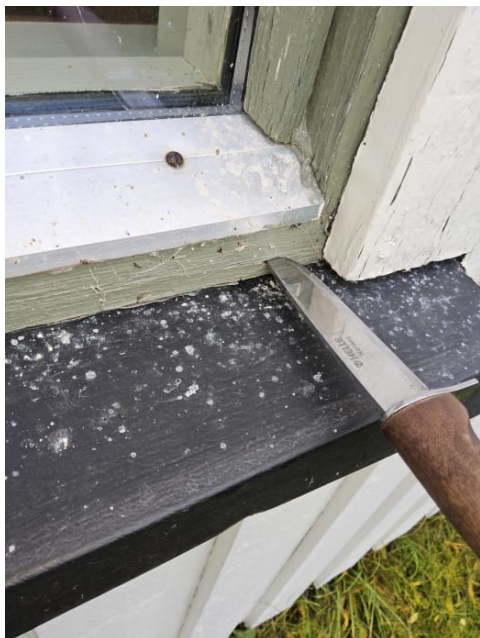
Bilde viser råteskadet vindu.
