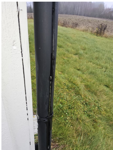
Bilde viser frostsprengt nedløpsrør.
