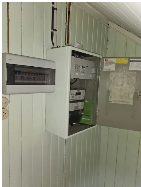
Bilde viser sikringsskap.
