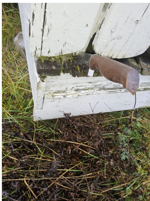
Bilde viser råteskade på terrassen.
