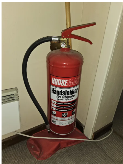
Bilde viser brannslukningsapparat.
