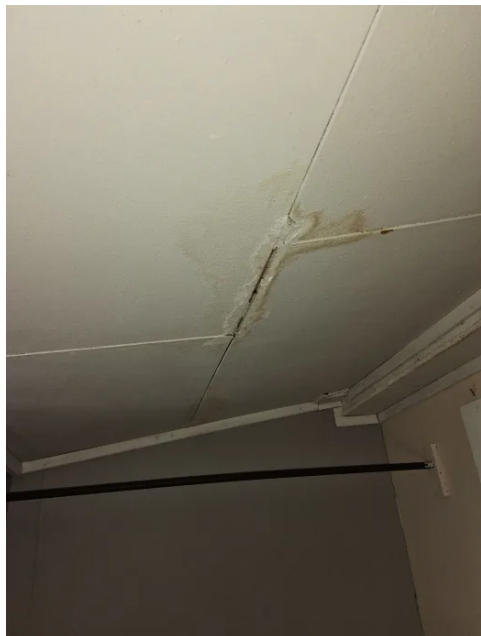
Bilde viser fuktskadet himling etter lekkasje.
