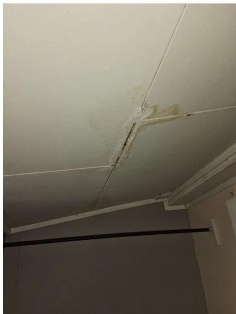
Bilde viser fuktskadet himling.
