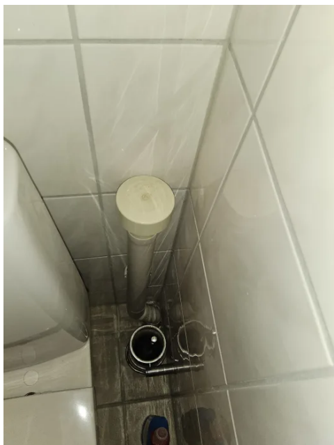
Bilde viser vakumventil på bad.
