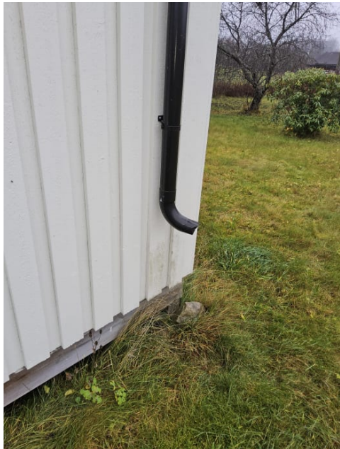
Bilde viser nedløpsrør avsluttet over bakken.
