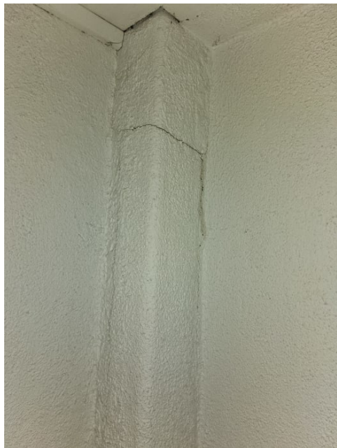
Bilde viser riss i skorsteinen.
