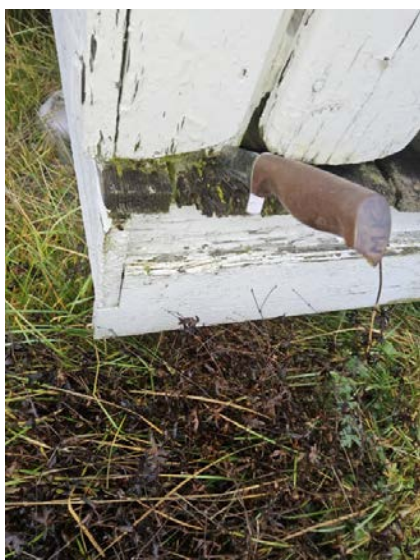
Bilde viser råteskade på terrassen.
