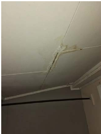
Bilde viser fuktskadet himling.
