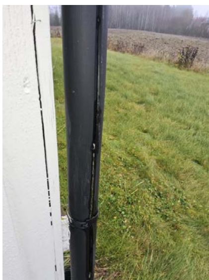
Bilde viser frostsprengt nedløpsrør.
