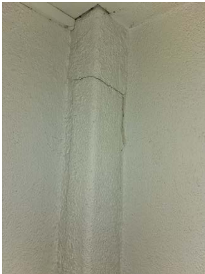
Bilde viser riss i skorsteinen.
