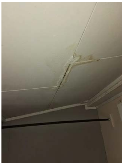
Bilde viser fuktskadede himling etter lekkasje.
