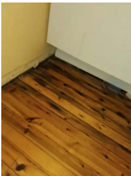
Bilde viser fuktmerker på gulv.
