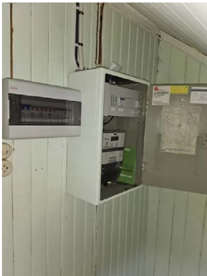
Bilde viser sikringsskap.
