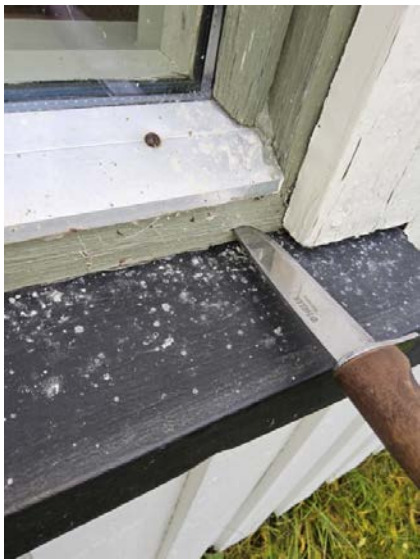
Bilde viser råteskadet vindu.
