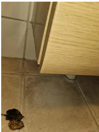
Bilde viser fuktskadet innredning.
