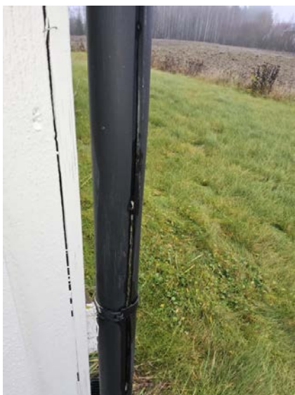
Bilde viser frostsprengt nedløpsrør.
