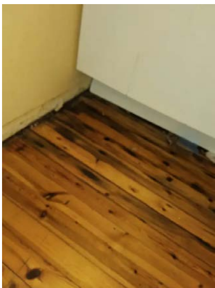
Bilde viser fuktmerker på gulv.
