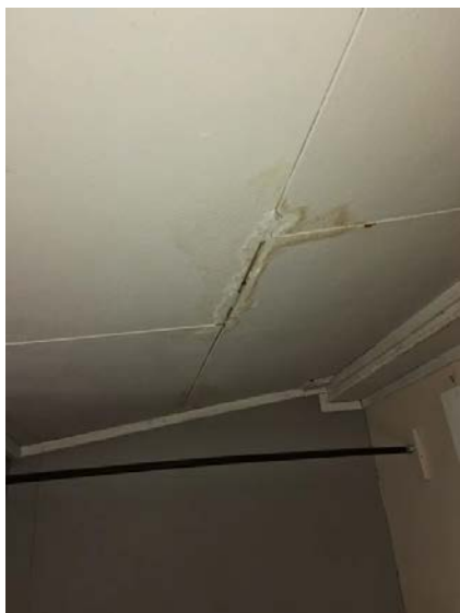
Bilde viser fuktskadet himling etter lekkasje.
