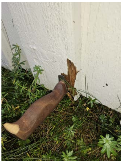
Bilde viser råteskade på yttervegg.
