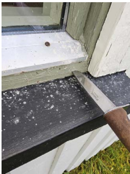
Bilde viser råteskadet vindu.
