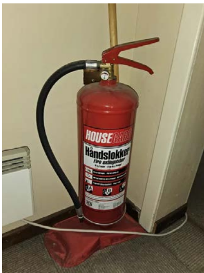
Bilde viser brannslukningsapparat.
