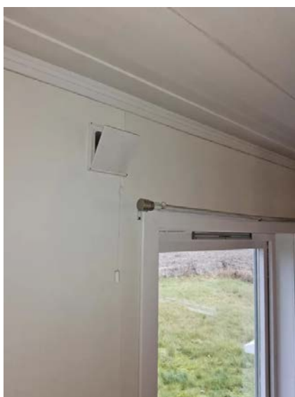
Bilde viser klaffventil på yttervegg og spalteventil i vindu.
