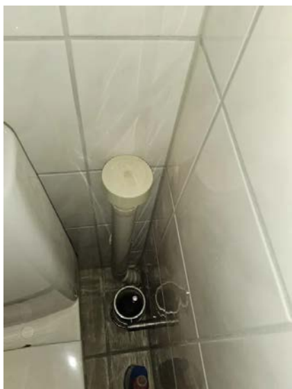
Bilde viser vakumventil på bad.
