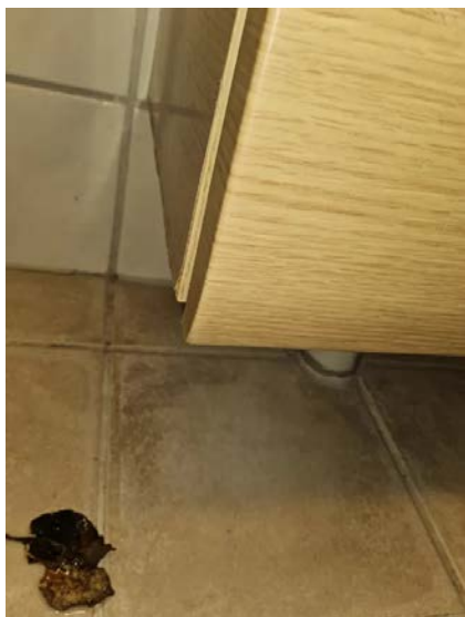
Bilde viser fuktskadet innredning.
