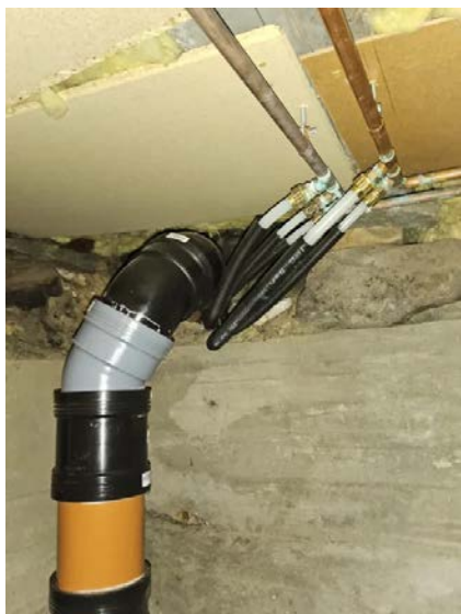
Bilde viser irr på koblinger til rør i rørsystem.
