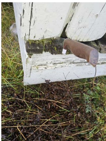
Bilde viser råteskade på terrassen.
