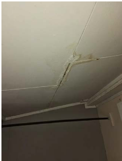
Bilde viser fuktskadet himling.
