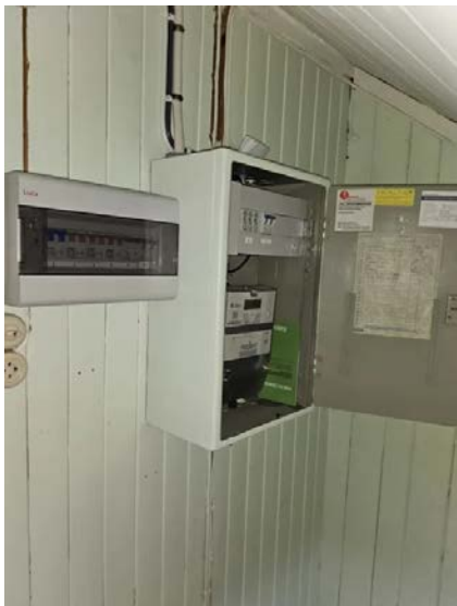
Bilde viser sikringsskap.
