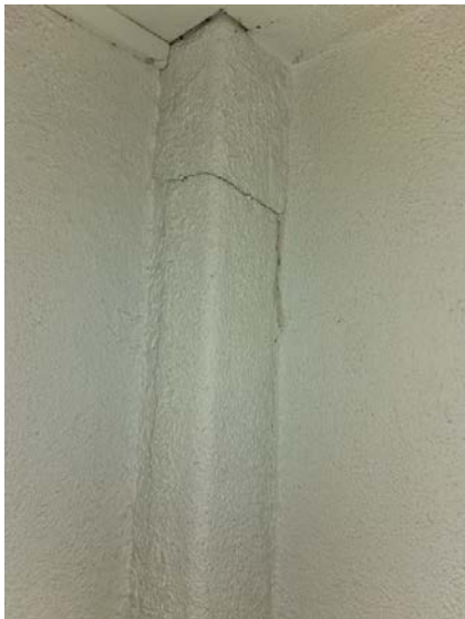
Bilde viser riss i skorsteinen.
