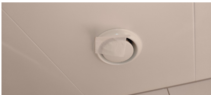
Funksjonstest av avtrekk.
