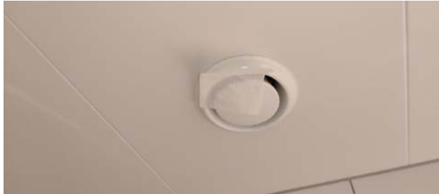
Funksjonstest av avtrekk.
