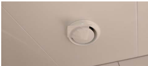
Funksjonstest av avtrekk.
