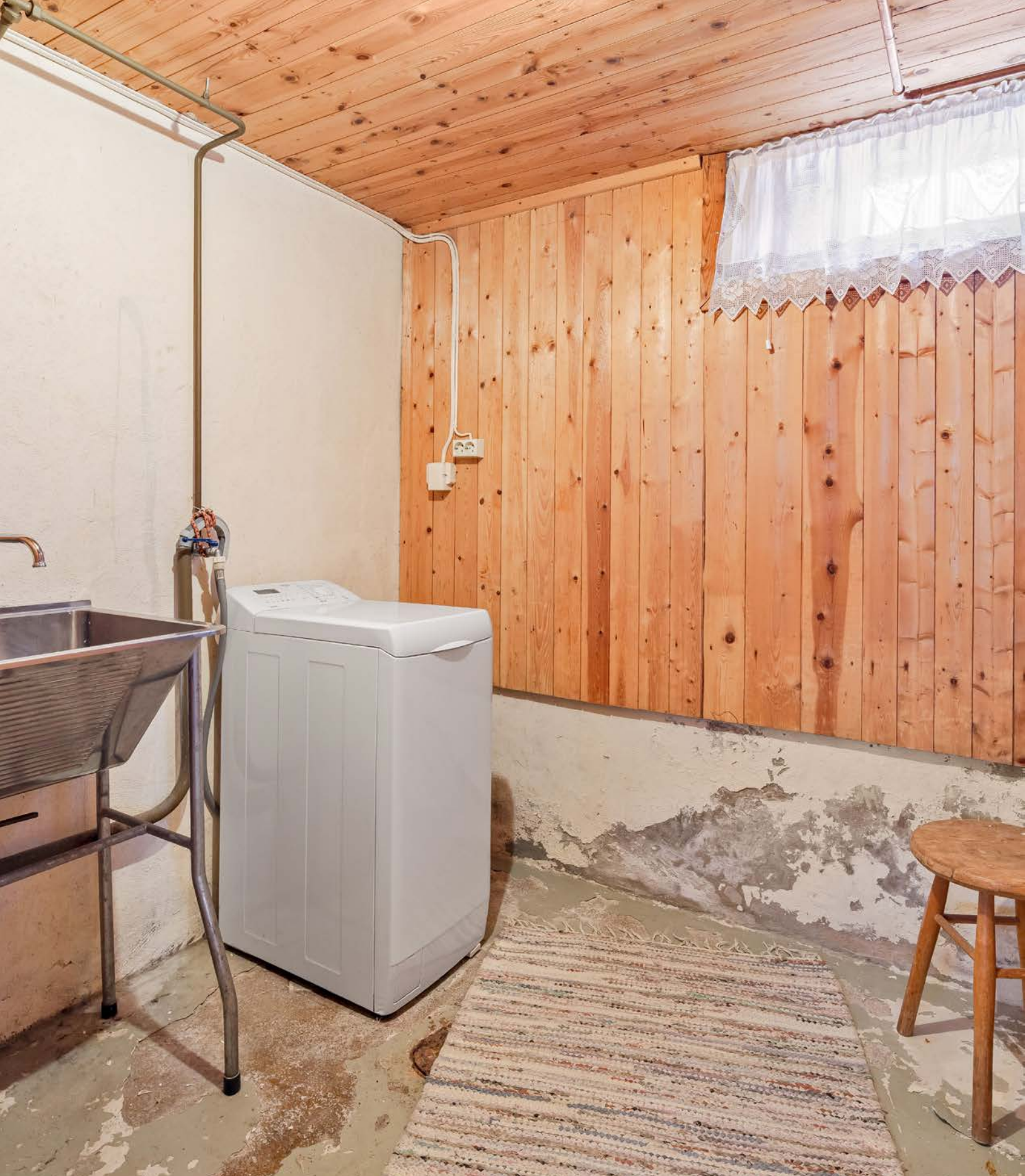
Enkelt vaskerom i kjeller med opplegg for vaskemaskin og utslagsvask.
