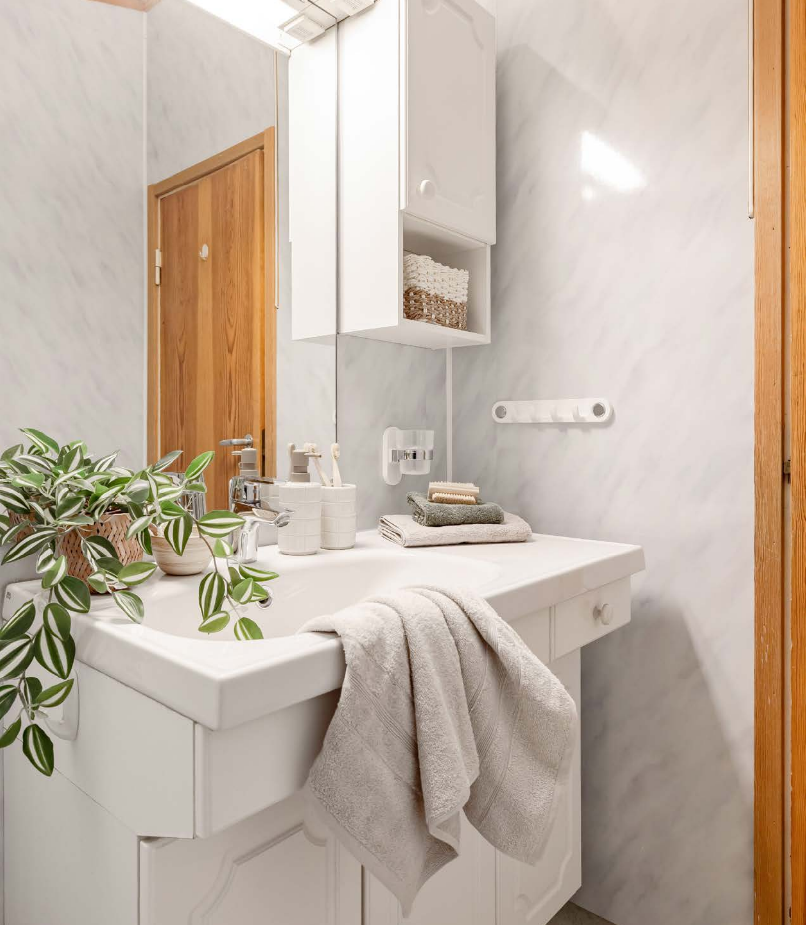
Baderomsinnredning med underskap og heldekkende servant. I overkant av servanten er det speil, lys med elektrisk uttak og veggskap.
