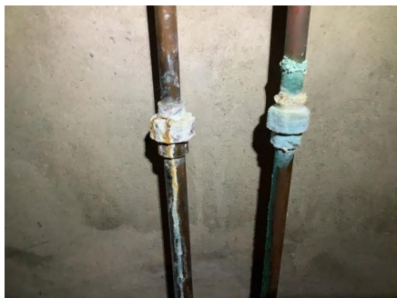
Betydelig irring på rør.
