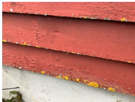
Mosedannelse på bordkledning.
