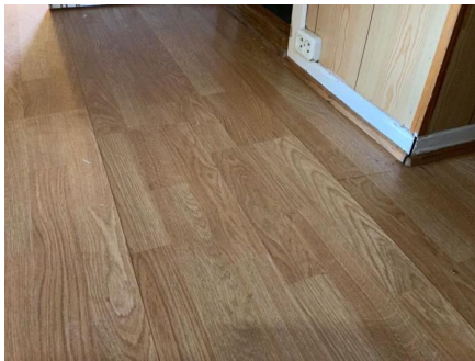
Fuktskadet laminatgulv i gang.
