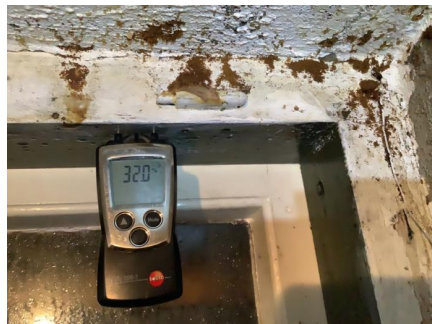
Skadelig fuktinnhold i vinduskarm, og symptom på fuktskader.
