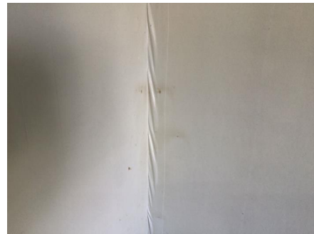
Tapet har løsnet og bølger seg i hjørne.
