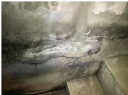
Saltutslag på murvegg.
