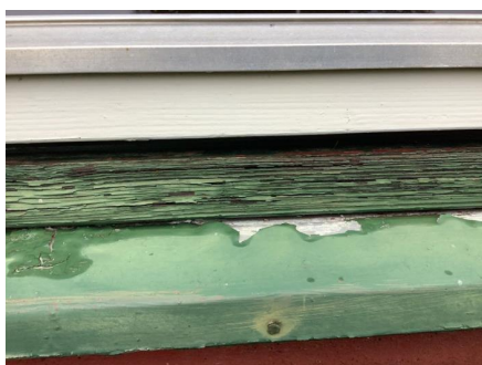
Eksempel på værslitt vindu.
