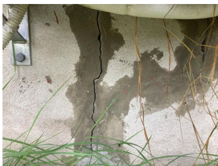
Eksempel på utvendig skråriss.
