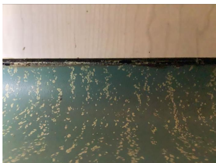
Utett overgang mellom vinylbelegg og baderomsplate.
