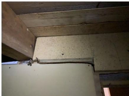
Det er ikke lufting i skråtak på loft.
