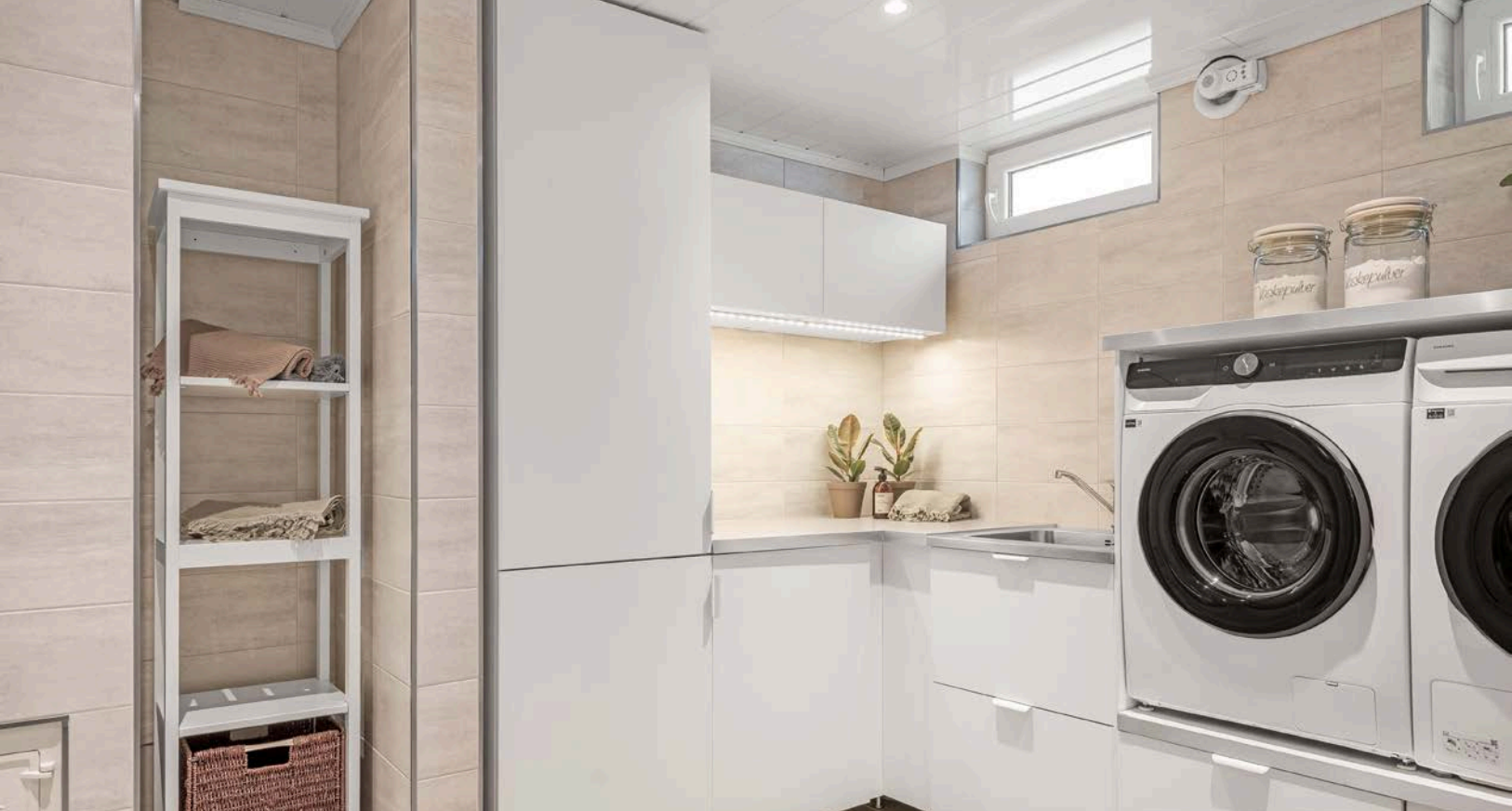
Vaskerommet har pene fliser på gulv og vegger, varmekabler i gulv, downlights i himlingen og elektrisk styrt vifte.
